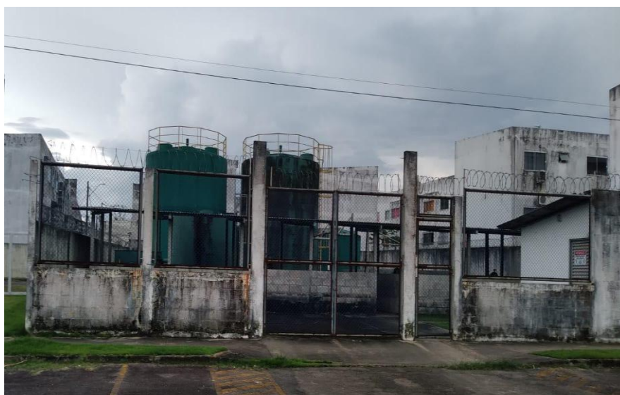
Figura 16 - Estação de tratamento e esgoto (ETE).
