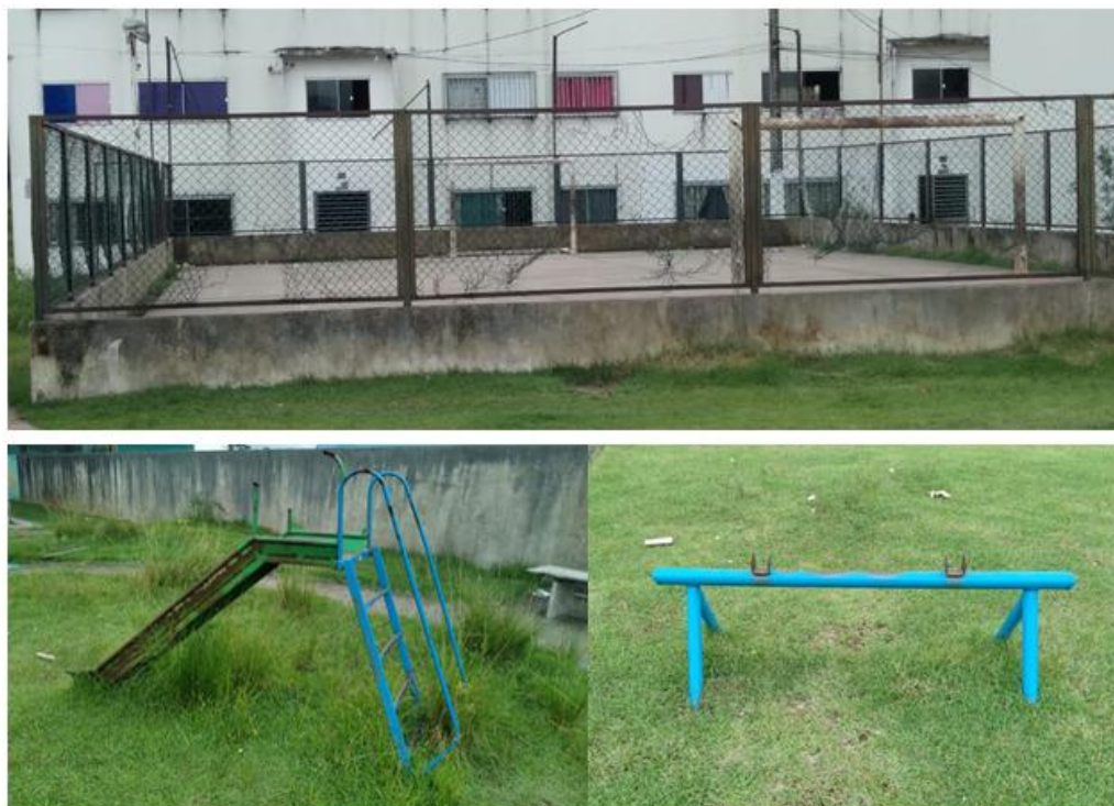
Figura 19 - Quadra poliesportiva com grades danificadas e mobiliários deteriorados.
