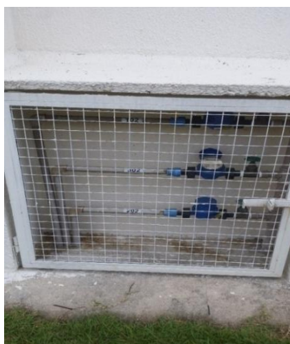
Figura 26 - Medidor individualizado de água.
