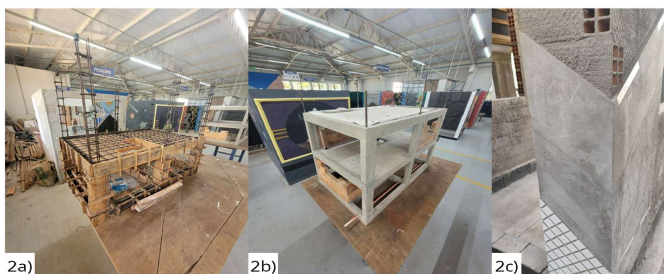
Figura 2 - 2a: Montagem de formas e ferragem de estruturas; 2b: Montagem de pórtico em concreto e alvenaria; 2c: Assentamento de revestimento em alvenaria.
