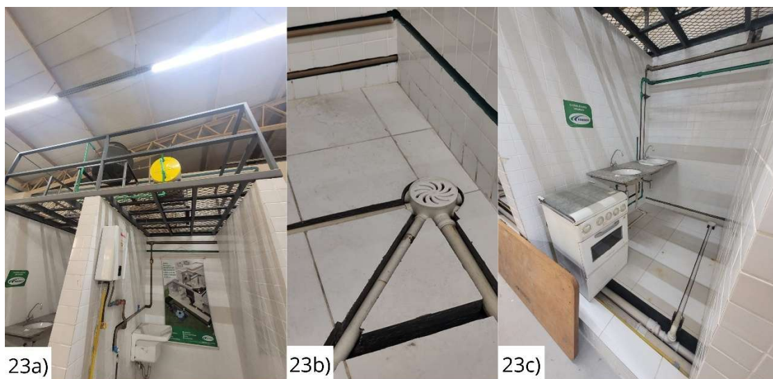
Figura 23 - 23a: Conjunto hidráulico com reservatório aparente; 23b: Instalações de esgoto sanitário; 23c: Sistema de Abastecimento e Drenagem Sanitária.
