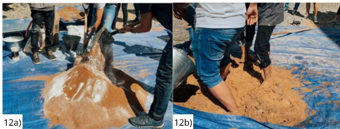
Figura 12 - 12a: Método de mistura com a pá para BTC; 12b: Método de mistura com os pés para adobes.
