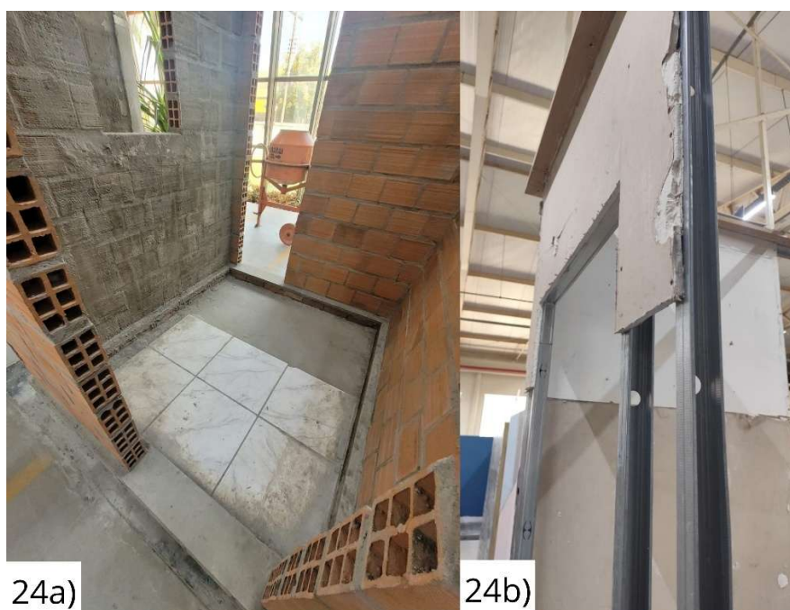
Figura 24 - 24a: Sistema de vedação em alvenaria e piso cerâmico; 24b: Sistema construtivo em Drywall .
