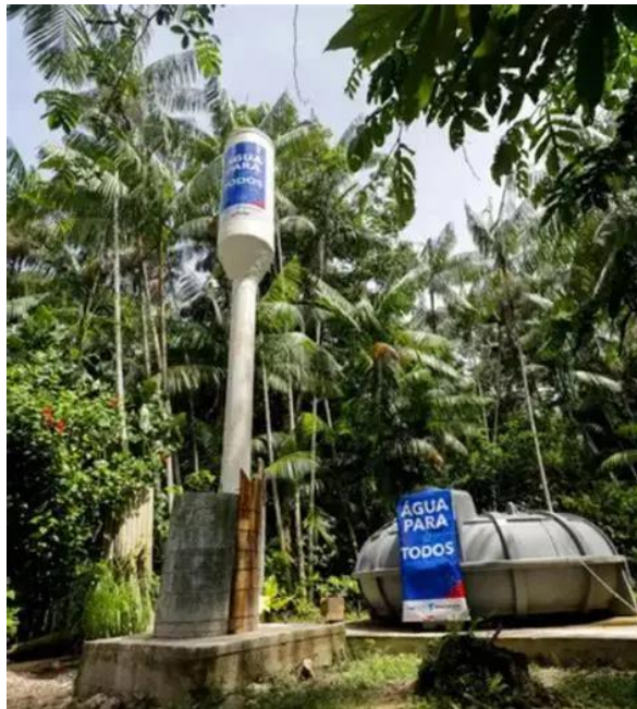
Figura 6: Estrutura de armazenamento de água da chuva em comunidade ribeirinha da Ilha do Combu
