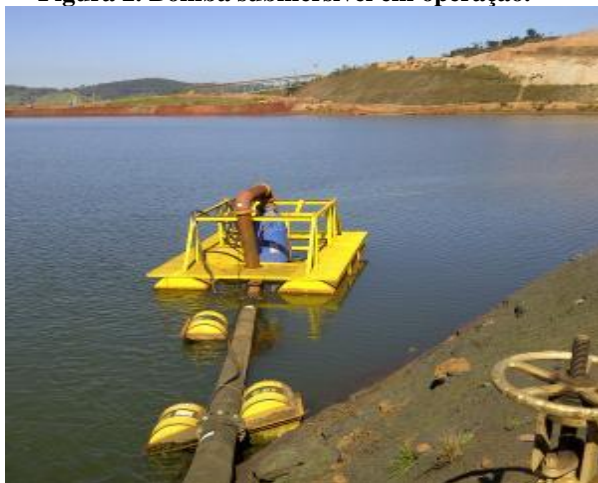
Figura 2. Bomba submersível em operação.
