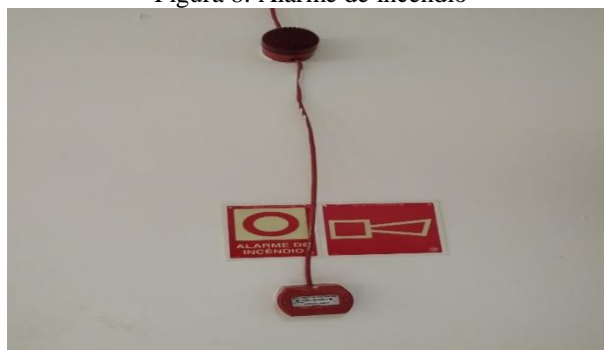
Figura 8: Alarme de incêndio
