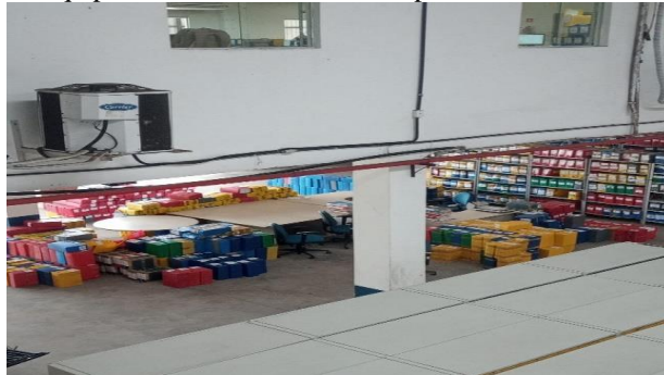
Figura 5: Equipamento de controle de temperatura - Ar-condicionado.
