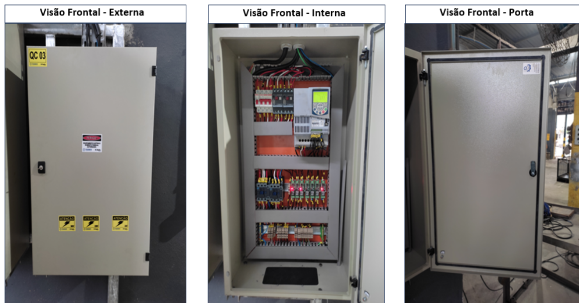
Figura 7 – Quadro de Comando depois da adequação
