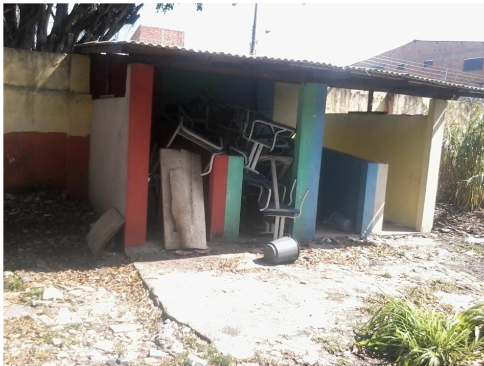
Imagem 1: Local que servia para armazenar os resíduos para coleta seletiva na Escola Estadual Dr. Agostinho Monteiro, mas que se transformou em depósito de cadeiras quebradas. Fonte: CORDOVIL, Wendell P. Machado. 2016.
