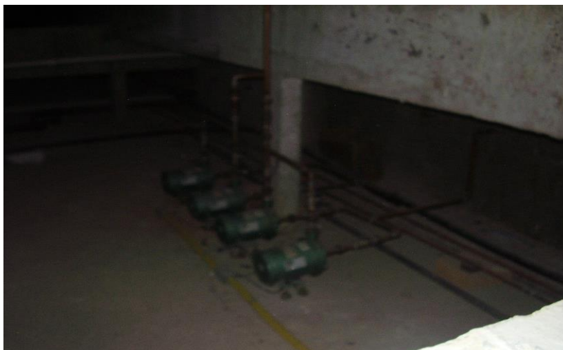
Figura 22 – Bombas de recirculação Fonte: Pesquisa direta, 2010
