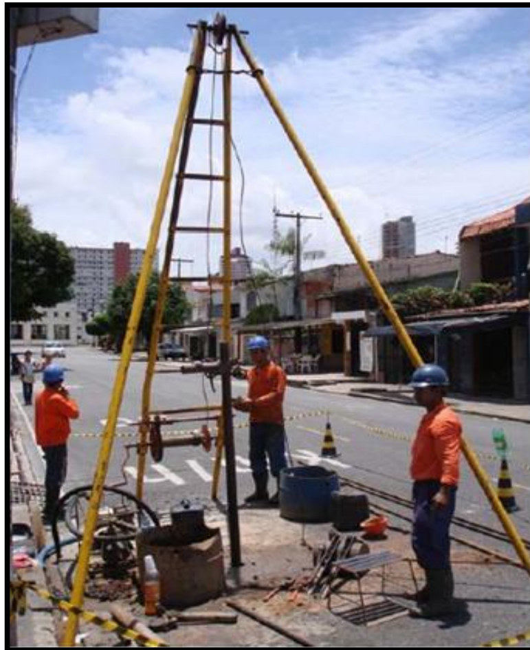
FIGURA 08 – Foto ilustrando o equipamento utilizado no furo de sondagem SPT-03, localizado na Rua Osvaldo de Caldas de Brito, esquina com a Rua Carlos de Carvalho.
