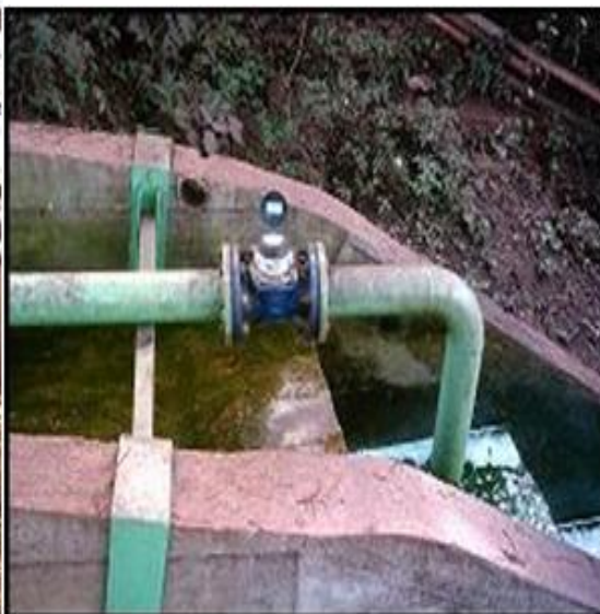
Figura 22: Medidor de vazão - saída (2006).
