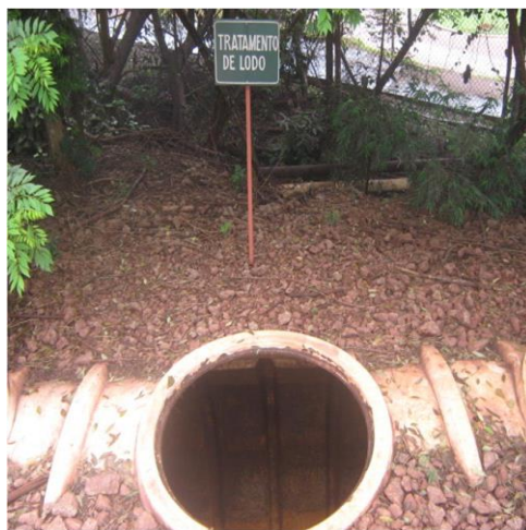
Figura 27: Tratamento do lodo do sistema da ETE compacta (2007).
