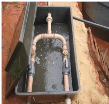
Figura 37: Caixa de controle de vazão da ETE de polimento (2009).
