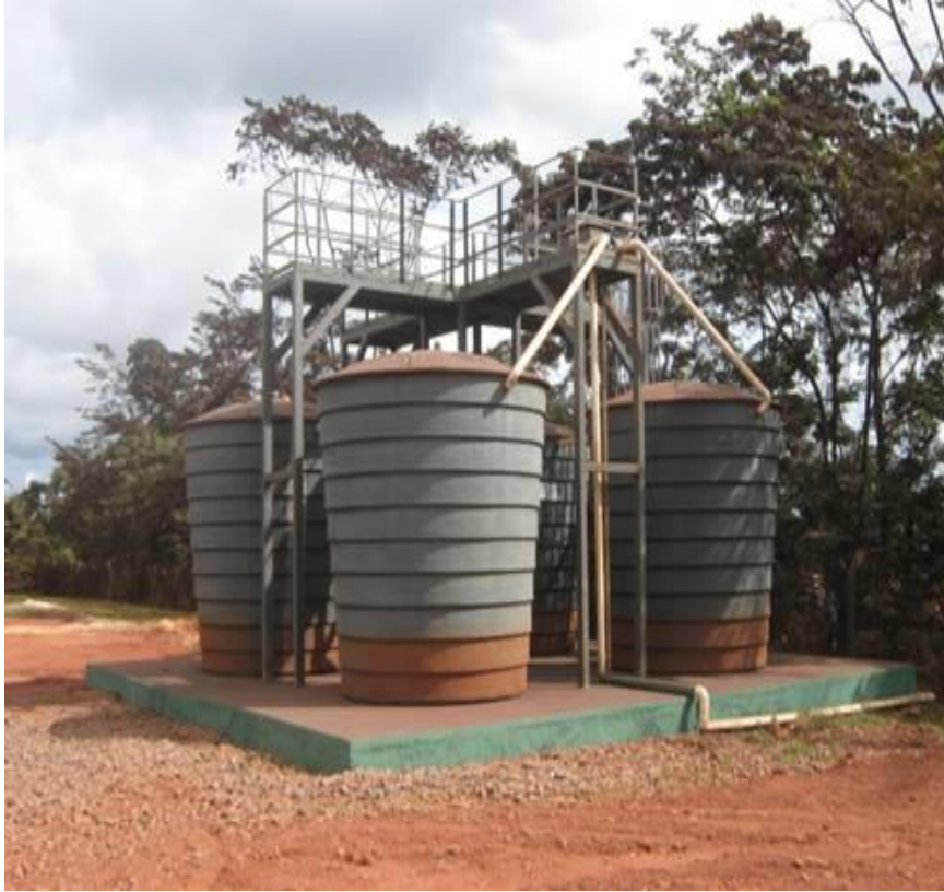
Figura 38: Filtros anaeróbios da ETE de polimento (2009).
