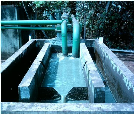
Figura 6 – Caixa partidora de vazão (2003).
