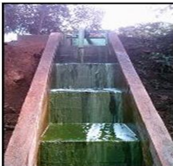
Figura 23: Escada de aeração da saída da ETE da mina de N4 (2006).
