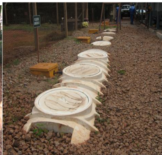
Figura 28: Tanque Anóxico do sistema da ETE compacta (2007).
