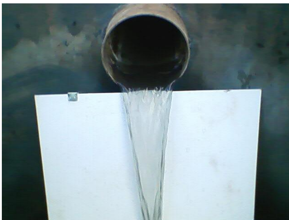
Figura 40: Saída do efluente tratado da ETE da Mina de N4 (2009).
