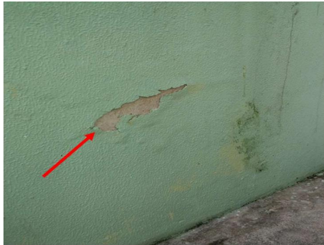
Figura 8 - Descascamento de pintura
