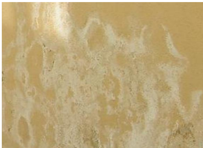
Figura 4 - Eflorescência em revestimento.
