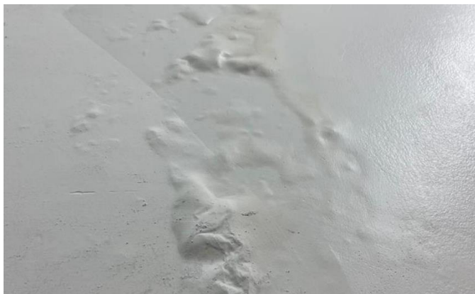
Figura 7 - Presença de bolhas na pintura
