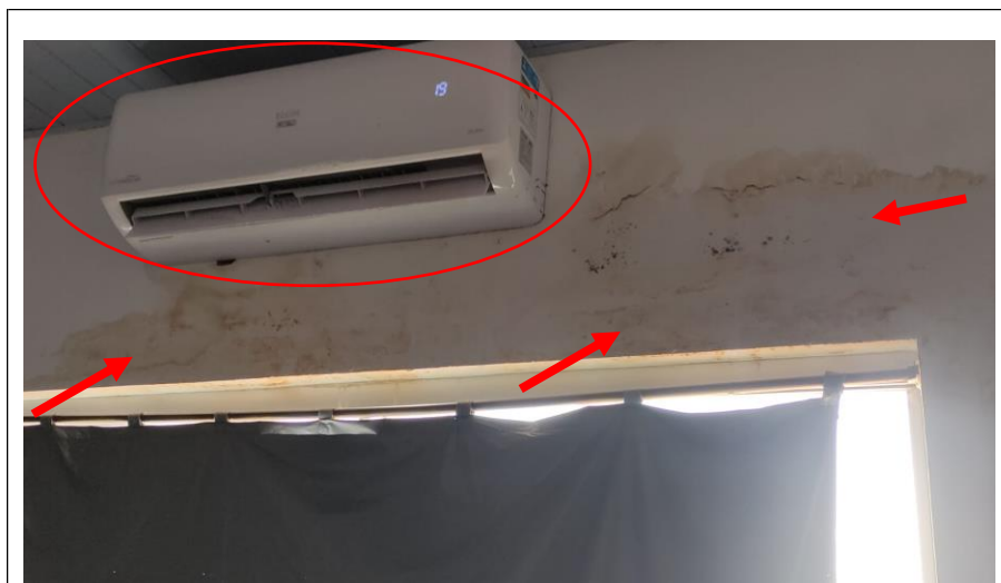
Quadro 13 - Mancha de umidade, na sala administrativa do 3° GBM.
