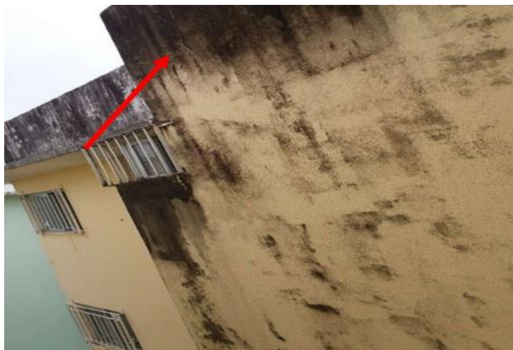
Figura 5 - Manchas de microrganismos em fachada.
