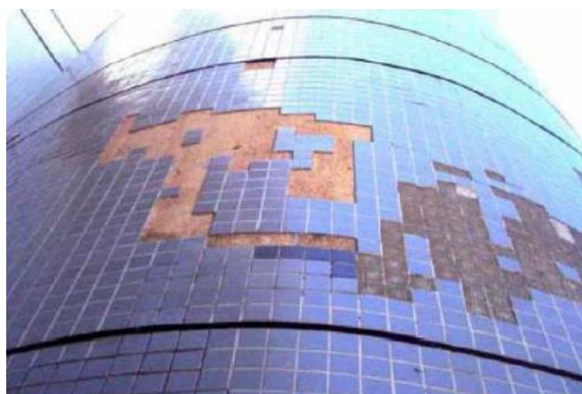
Figura 6 - Destacamento do revestimento cerâmico de fachada.
