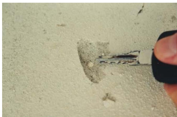
Figura 9 - Vesícula no revestimento em argamassa.
