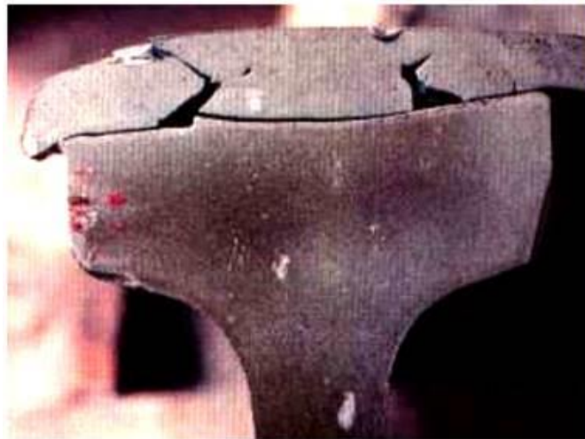
Figura 11 – Trinca horizontal no boleto.
