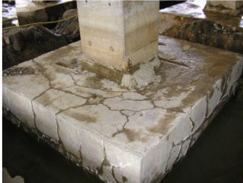
Figura 6 – Bloco de fundação com fissuração causada por RAA
