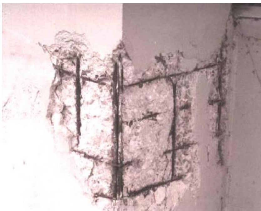
Figura 8 – Corrosão de armadura por cloreto.
