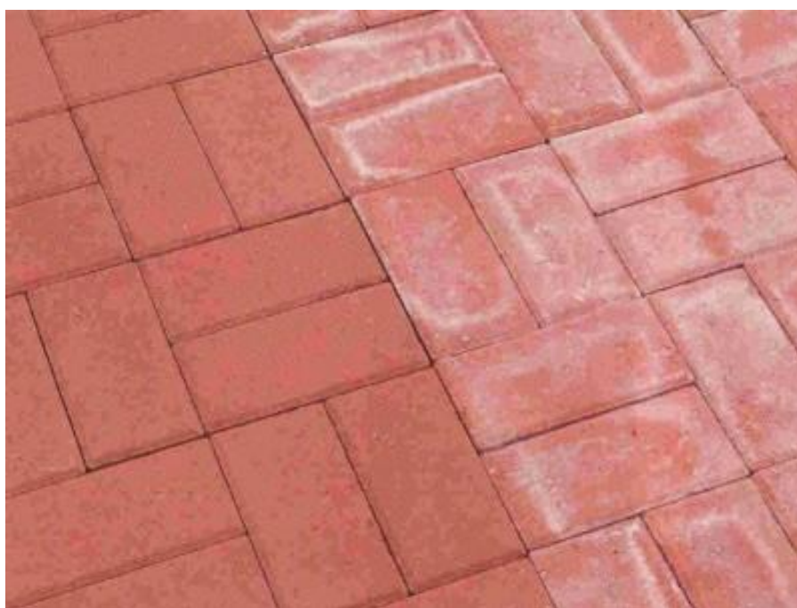
Figura 26: Eflorescência em blocos de concreto colorido.
