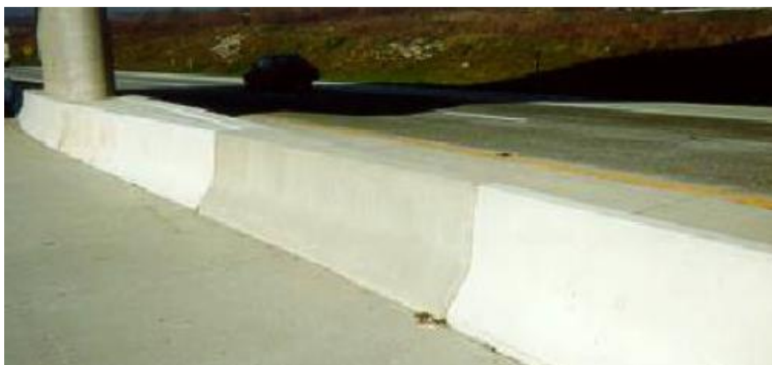
Figura 14: Barreiras de concreto branco e cinza.
