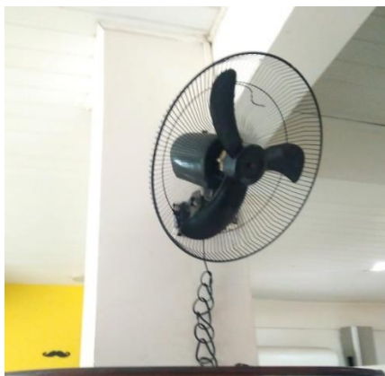
Figura 2.12 – Ventilador de parede usado na panificadora.
