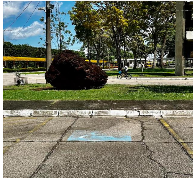
Figura 40 - Sinalização horizontal desgastada
