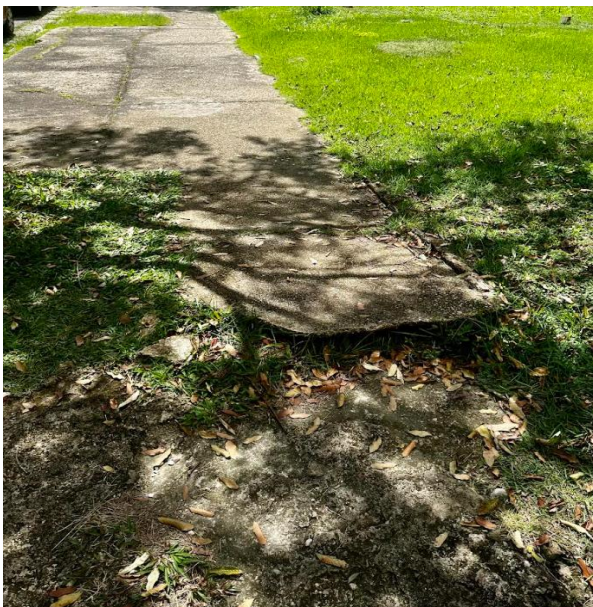
Figura 34 - Trecho da calçada danificado
