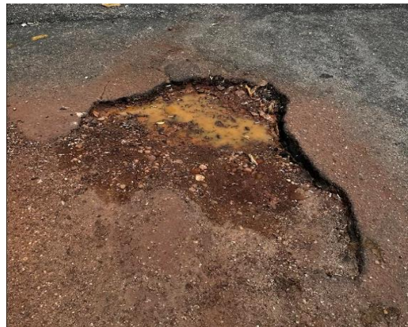
Figura 28 - Defeito observado no pavimento: panela
