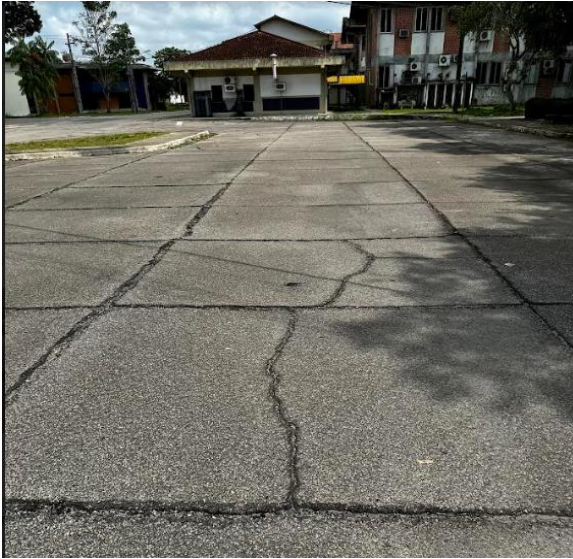
Figura 25 - Defeito observado no pavimento: trinca em bloco
