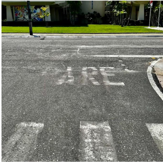
Figura 32 - Sinalização horizontal desgastada
