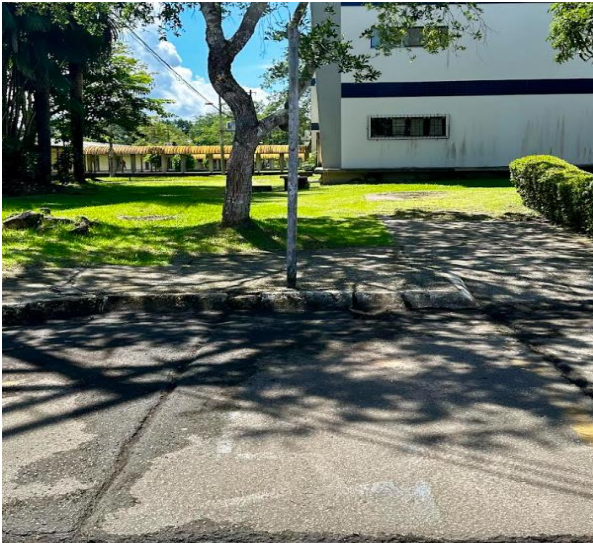
Figura 39 - Sinalização vertical quebrada e horizontal desgastada
