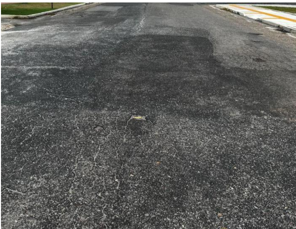
Figura 27 - Defeito observado no pavimento: remendo
