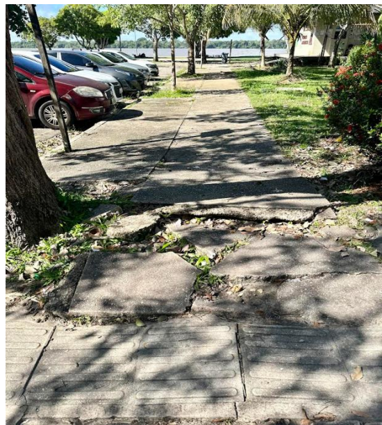
Figura 35 - Trecho da calçada danificado
