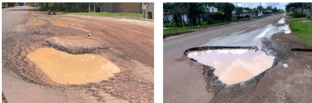
Figura 20 – Painéis de alta severidade presentes no trecho crítico.
