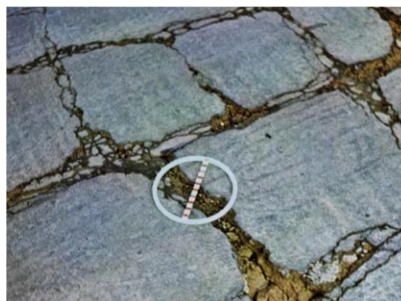
Figura A.4 - Trinca tipo “Bloco”.
