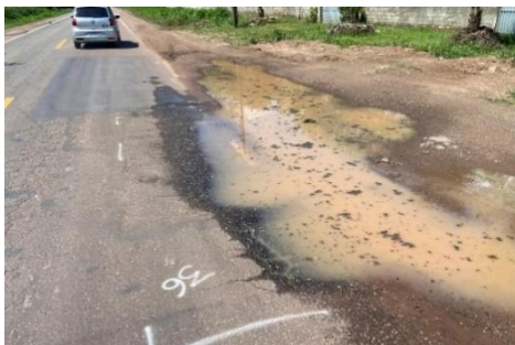
Figura 21 – Ineficiência e ausência dos elementos de drenagem no trecho crítico.
