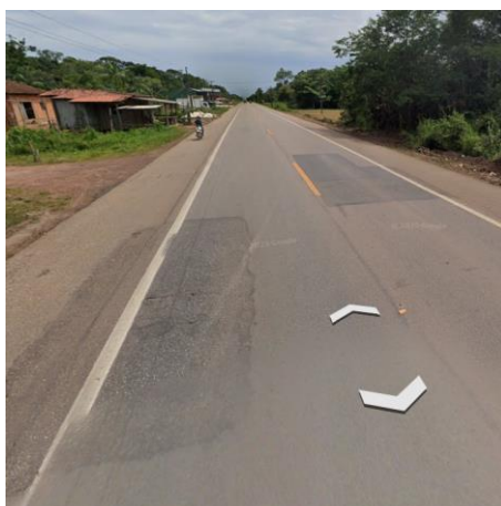
Figura 24 – Registro de remendos observadas em março no Trecho 2.
