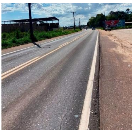
Figura 23 – Afundamentos de trilha de roda no Trecho 1 no mês de julho.
