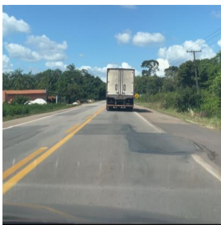
Figura 25 – Registro de remendos observadas em julho no Trecho 3
