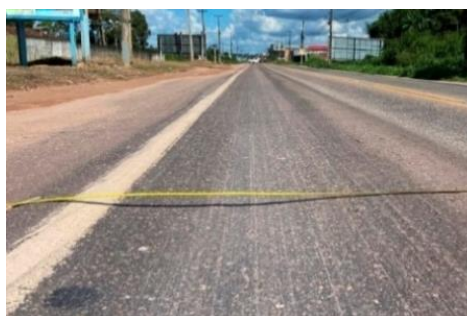
Figura 22 – Afundamento de consolidação de trilha de roda presente no trecho 1.
