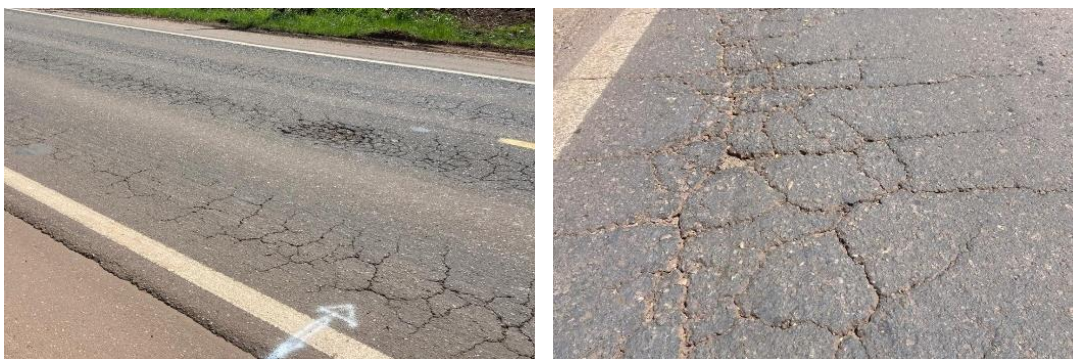
Figura 19 – Trincas interligadas do tipo “jacaré” presentes no trecho crítico.
