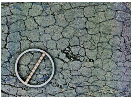
Figura A.3 - Trinca tipo “Couro de Jacaré”.
