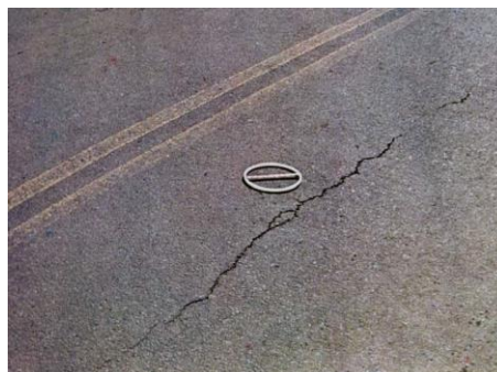
Figura A.2 - Trinca isolada longitudinal.
