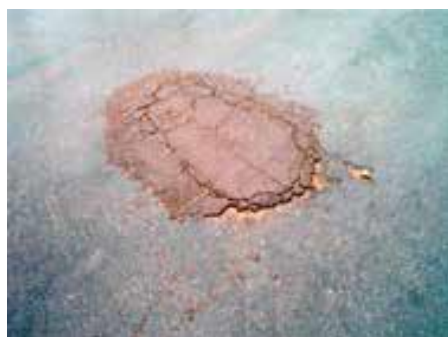
Figura A.11 – Remendo mal executado.
