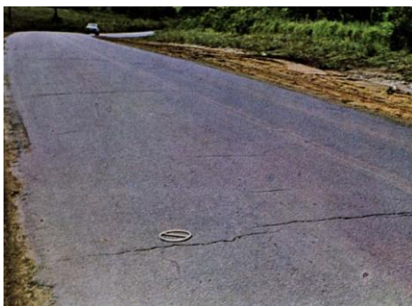
Figura A.1 - Trinca isolada transversal.
