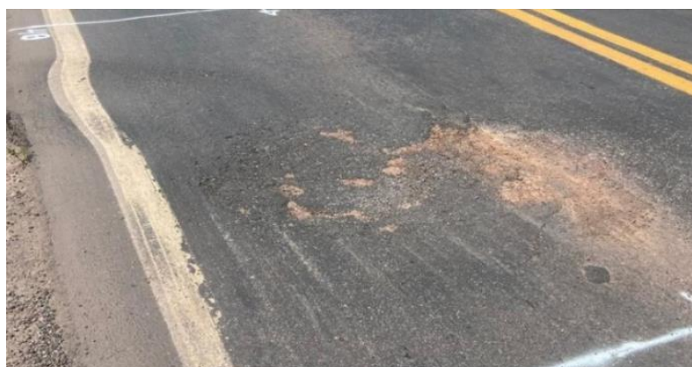
Figura 18 – Ondulações e trincas interligadas tipo “jacaré”, com erosão nas bordas, presentes no trecho crítico.
