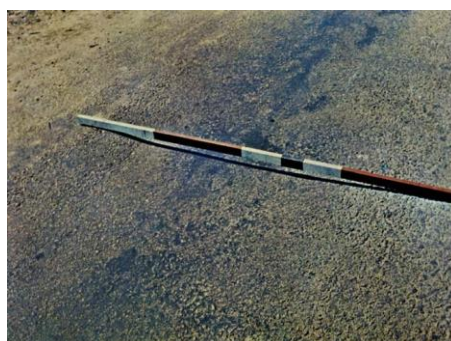
Figura A.6 - Afundamento de consolidação.
