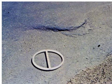
Figura A.8 – Escorregamento.
