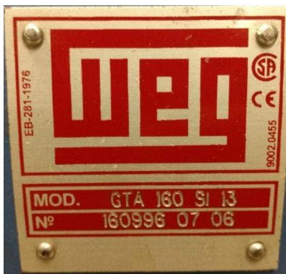
Figura 15 — Placa de identificação do Gerador
