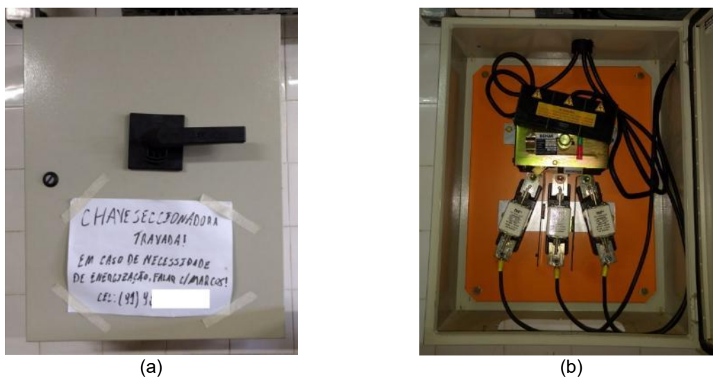
Figura 27 – (a) Visão frontal da chave seccionadora geral da Bancada Dinâmica, localizada no LabEP; (b) Vista interna da Chave Seccionadora geral da Bancada Dinâmica.
