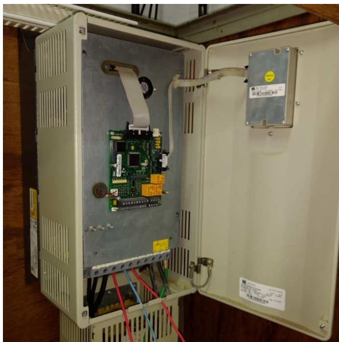
Figura 83 – Foto do Inversor com a tampa aberta, mostrando seu interior.
