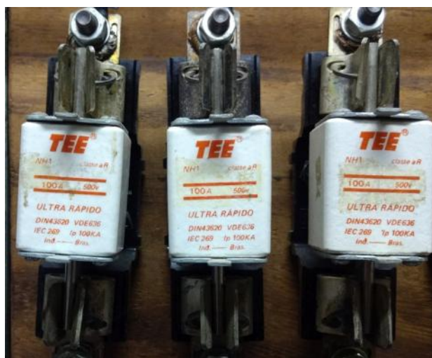
Figura 37 – Fusíveis de proteção geral do circuito de força da Bancada Dinâmica
