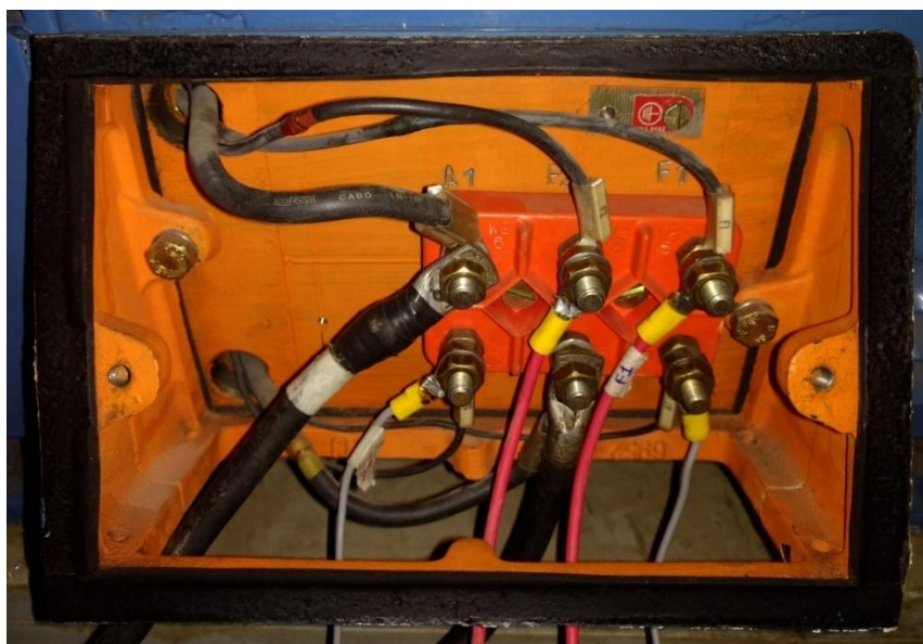
Figura 62 – conexões de força do Motor.
