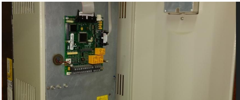
Figura 84 – foto das conexões de controle do Inversor.
