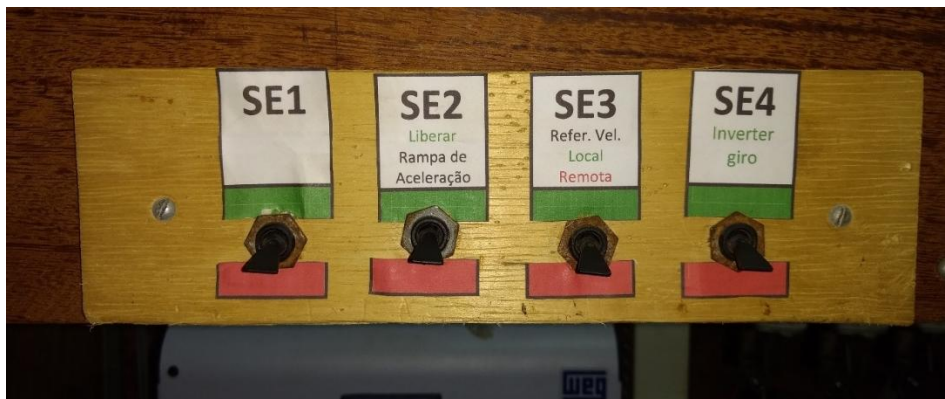
Figura 91 – Foto das Chaves de Habilitação SE2-SE4, todas desabilitadas.
