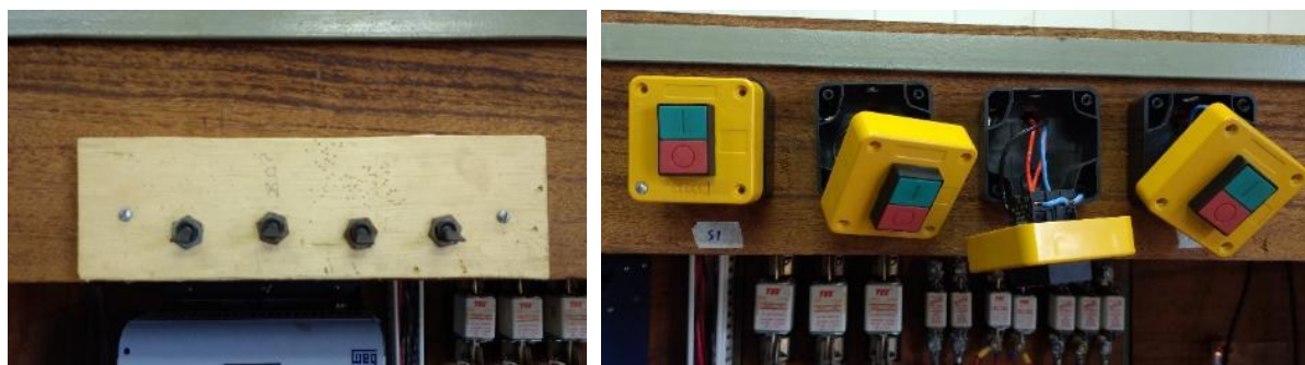
Figura 26 – (a) Chaves de habilitação na nova instalação; (b) Botões de comando na nova instalação parcial.
