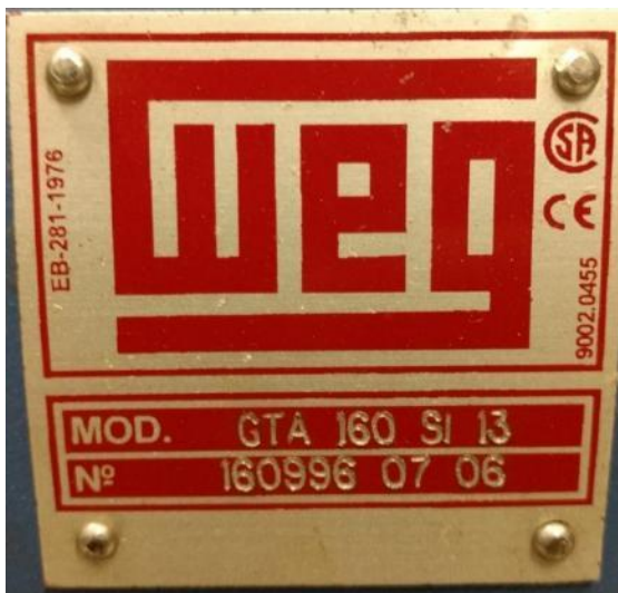
Figura 67 — Placa de identificação do Gerador
