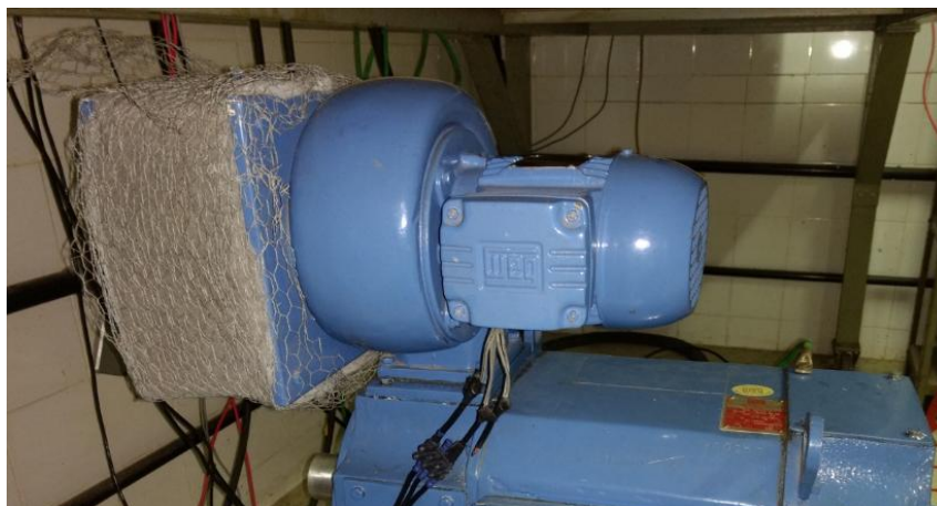
Figura 12 — Sistema de ventilação forçada do Motor CC
