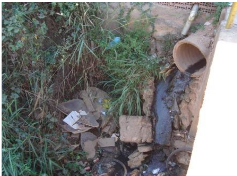
Fotografia 22 - Lançamento de entulhos e esgoto no córrego. Fonte: Silva (2007).
