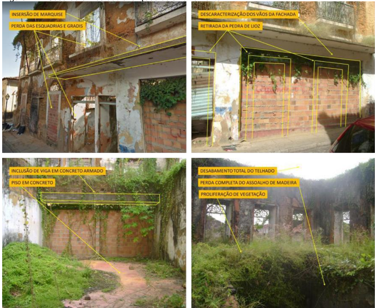
Figura 12 – Casarão em estado avançado de arruinação.
