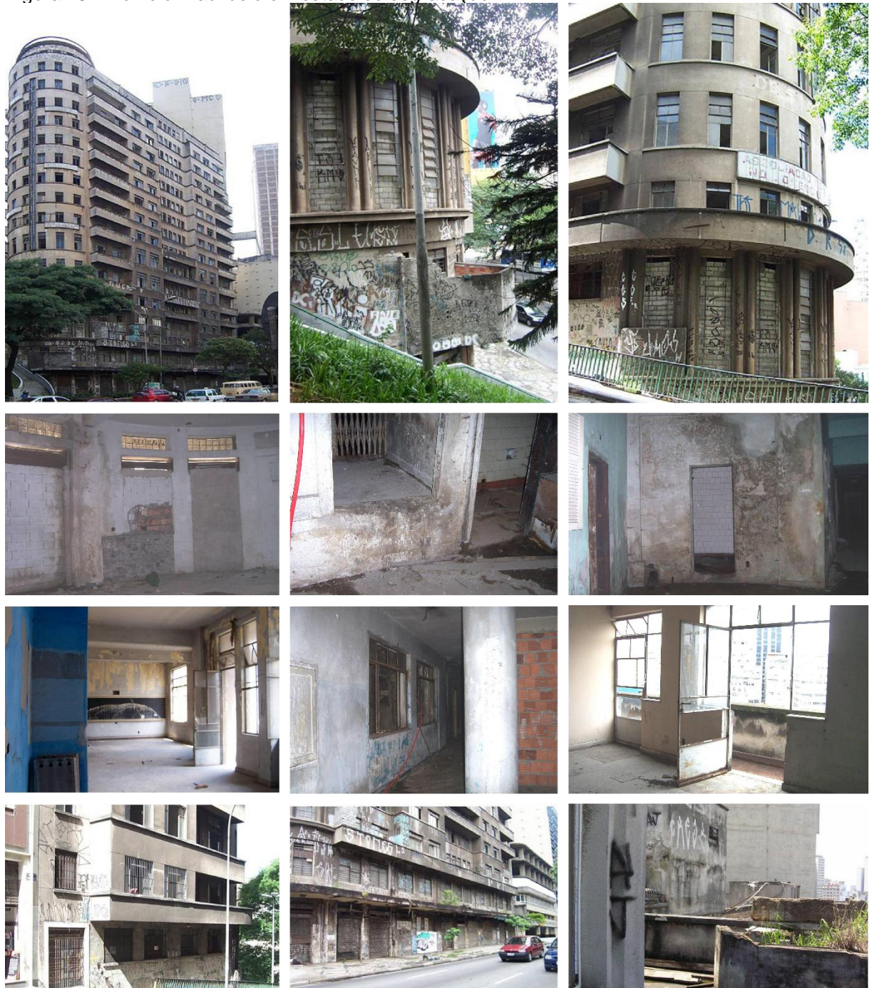
Figura 18 – Edifício Riachuelo em estado de degradação.
