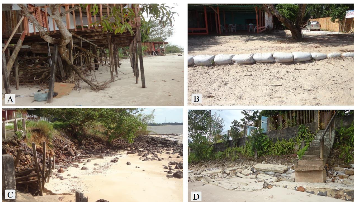
Figura 34-Obras de proteção realizadas anteriormente às construções do muro de arrimo. A) São Francisco- Palafitas; B) Marahú- Bolsões de areia; C) Cachimbo- Barreiras de rochas; D) São Francisco- Bolsões de concreto. Foto retirada em: 09/11/2016 e 19/06/2017.
