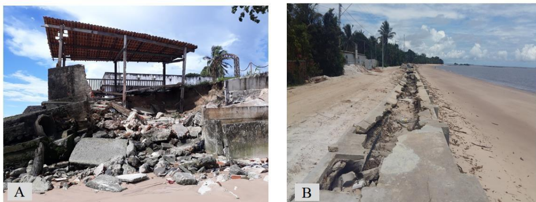
Figura 22-Representação das praias afetadas pela combinação de processos hidrodinâmicos. (A) Praia grande: Casa destruída. (B) Marahú: Muro de arrimo danificado. Fotografias retiradas em: 16/05/2019. Fonte: Próprio Autor.
