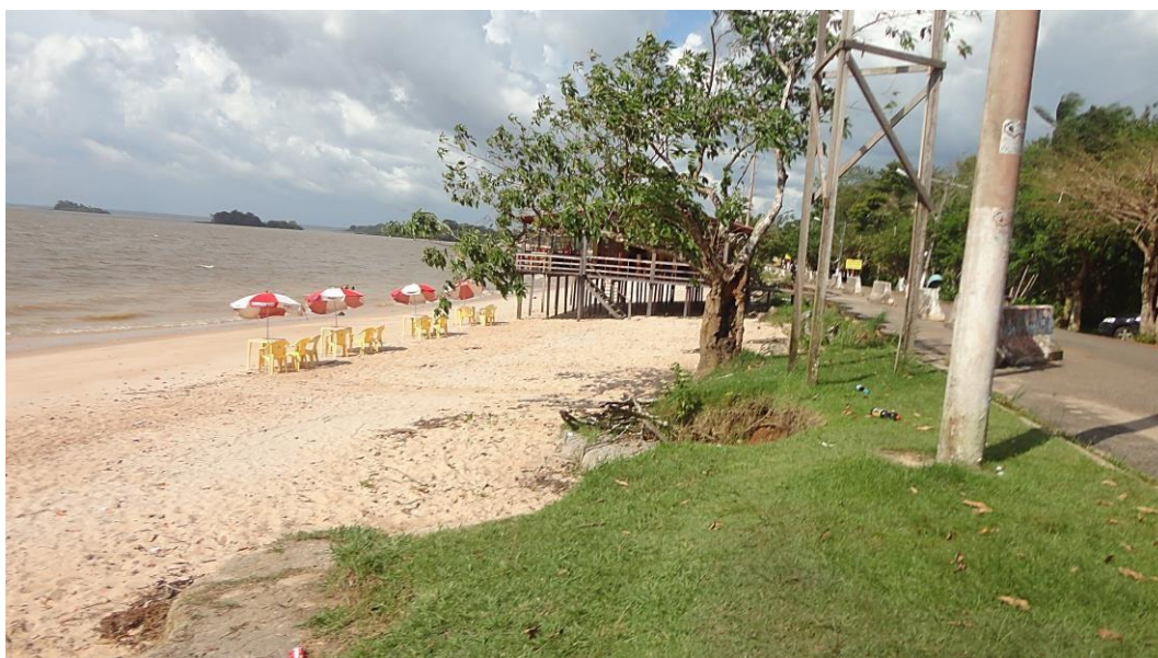
Figura 23-Exemplificação das erosões na margem fluvial ocorridas na Praia do Paraíso. Fotografia retirada em: 19/06/2017 (antes da construção da nova orla).
