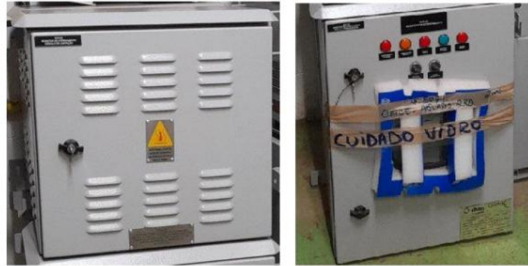
Figura 37 – Resistor de aterramento aguardando priorização de OM para instalação.
