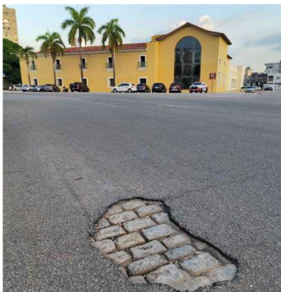
Figura 38 – Buraco no asfaltamento da Av. 16 de Novembro em frente ao São José Liberto
