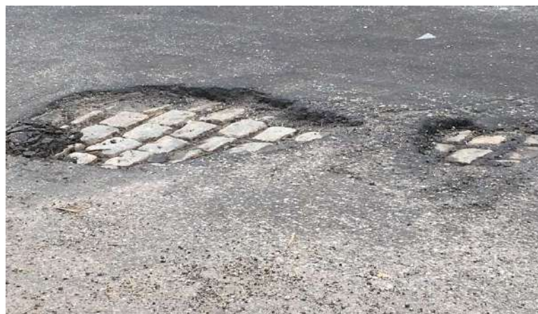
Figura 39 – Buraco no asfaltamento entre a Praça Osvaldo Cruz e o Assaí Atacadista
