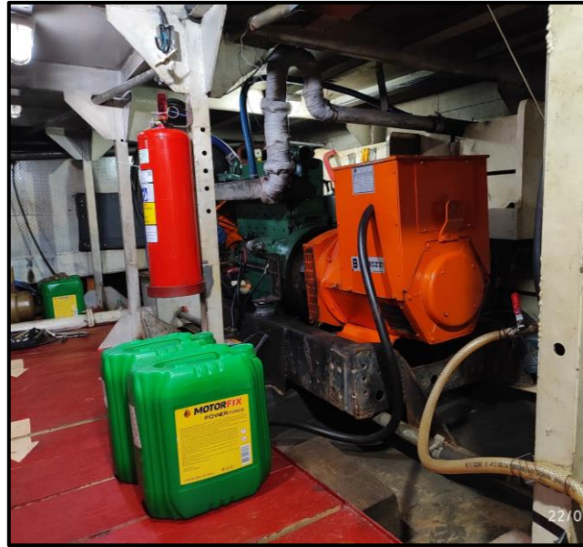
Figura 9 – Gerador diesel de 125kva.
