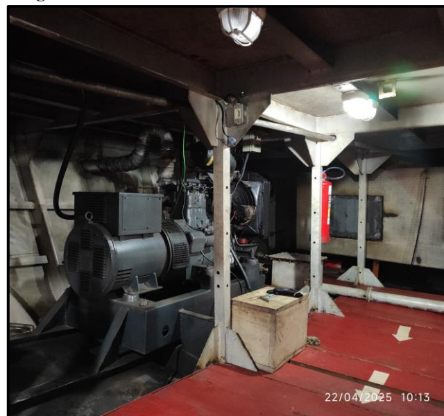
Figura 8 – Gerador diesel de 75kva.
