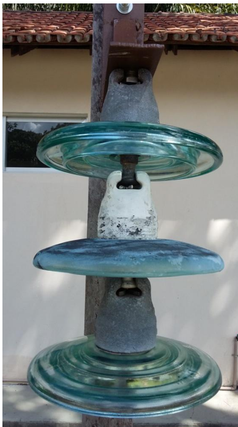
Figura 34 - Cadeia com três isoladores exposta na UFPA de Abaetetuba, na qual apenas o isolador do meio está com parte do corpo dielétrico revestido com a película super-hidrofóbica e sujo com pó de grafite
