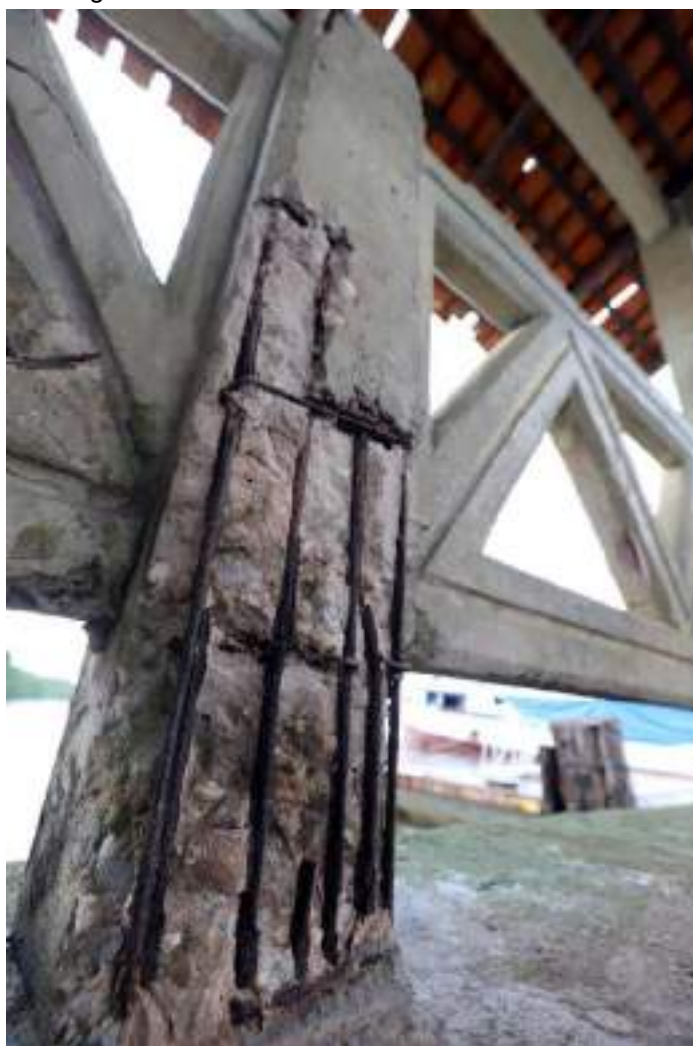
Figura 46: Desgaste e corrosão no acesso ao Terminal Hidroviário de Camará
