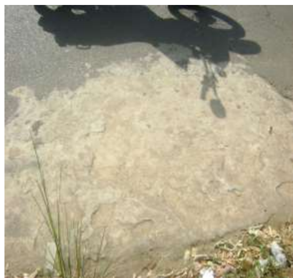
Figura 4.36B: Travessa W3 – Presença de derrame de materiais.
