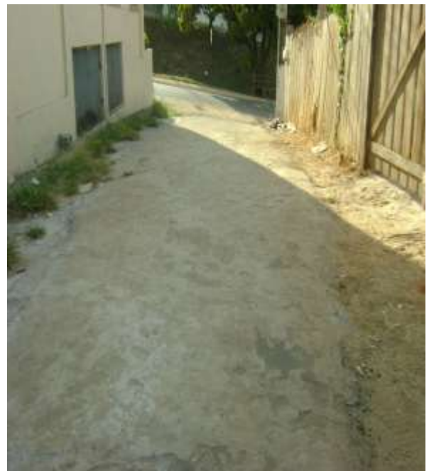
Figura 4.12D: Rua Fortaleza – Presença de derrame de material e desgaste no revestimento asfáltico.
