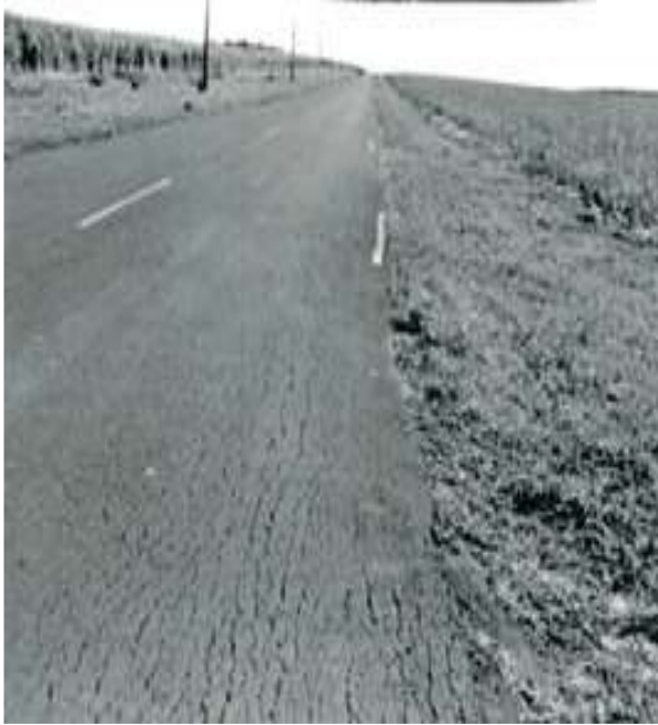
Figura 2.6A: Trincamento nos Bordos. Fonte: Bernucci et.al. (2008).
