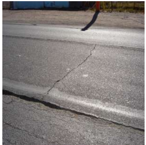
Figura 2.4D: Trincas por Reflexão. Disponível em: < http://www.ebah.com.br/content/ABAAABBRgAE/defeitos-pavimentos >. Acesso em: 13 março 2012.
