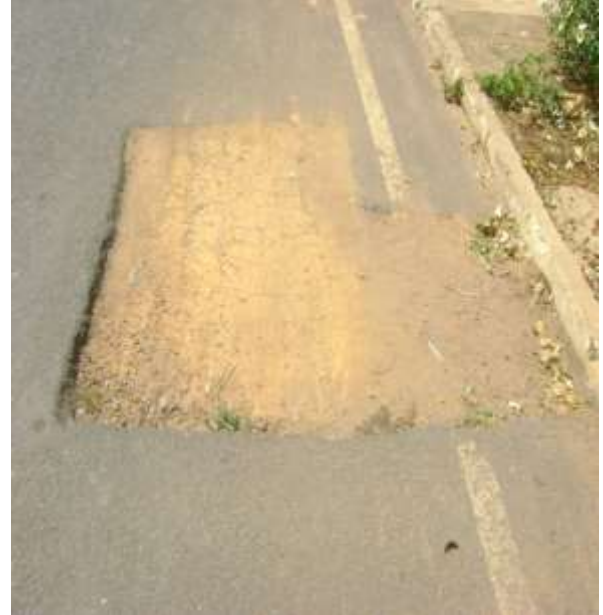
Figura 4.8B: Avenida Perimetral – Presença de panela na via.
