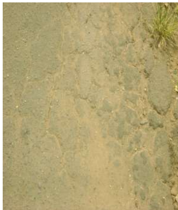
Figura 4.33B: Rua São Raimundo – Presença de trincas de reflexão.
