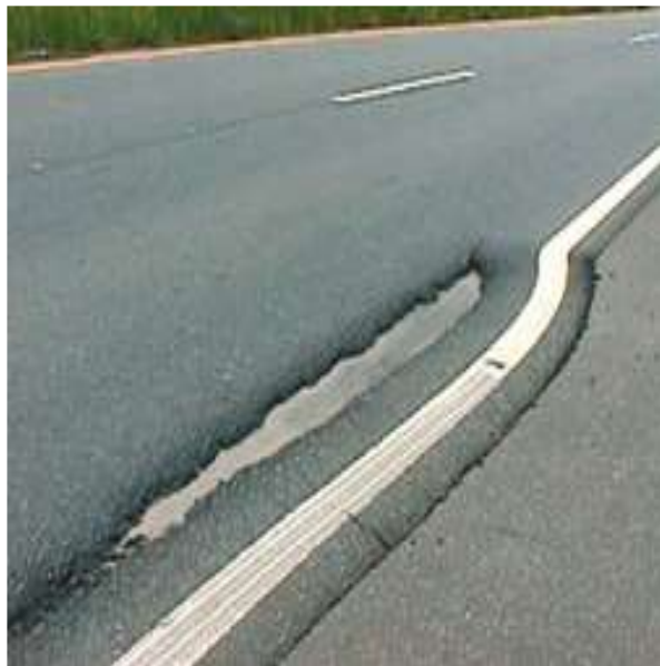
Figura 2.6C: Desnível entre a pista de rodagem e o acostamento. Fonte: Bernucci et.al. (2008).
