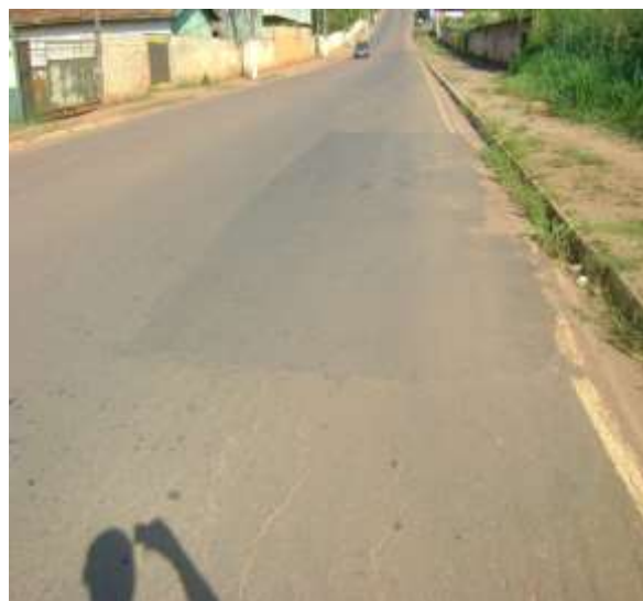
Figura 4.43B: Avenida Tancredo Neves – Presença de remendo e trincas de retração no logradouro.
