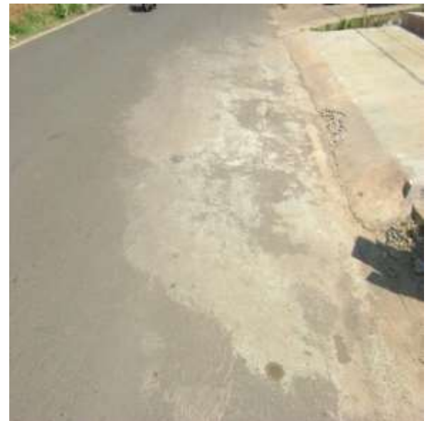
Figura 4.8D: Avenida Perimetral – Presença de derrame de materiais na via.
