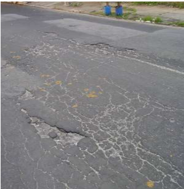
Figura 2.4C: Trincas em Blocos. Disponível em: < http://www.ebah.com.br/content/ABAAABBRgAE/defeitos-pavimentos >. Acesso em: 13 março 2012.
