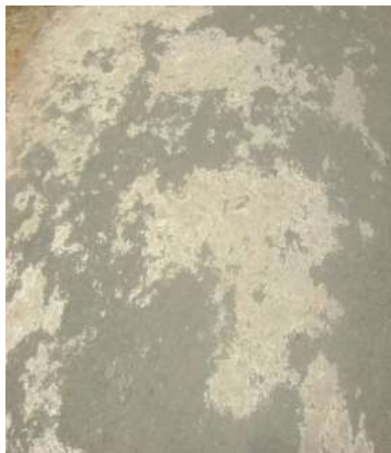
Figura 4.34B: Travessa W1 – Presença de derrame de materiais.
