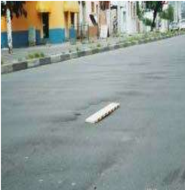
Figura 2.5C: Corrugação. Fonte: Danieleski (2004).
