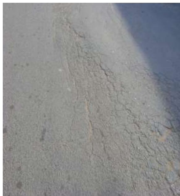
Figura 4.41B: Avenida Sete de Setembro – Presença de trincas de reflexão.
