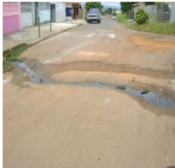
Figura 4.13B: Ala 01 – Presença de panelas e desgaste superficial na via.
