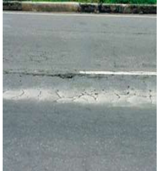
Figura 2.6B: Bombeamento dos finos do subleito para a superfície de rodagem. Fonte: Bernucci et.al. (2008).
