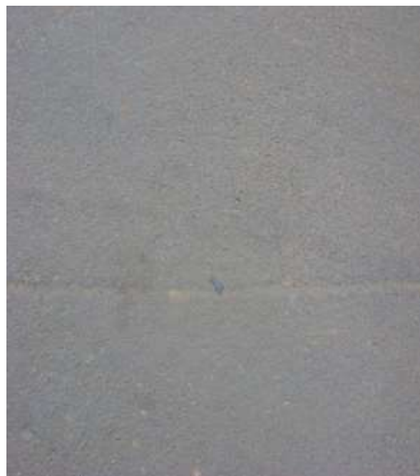
Figura 4.32B: Rua dos Cravos – Presença de desgaste superficial na via.
