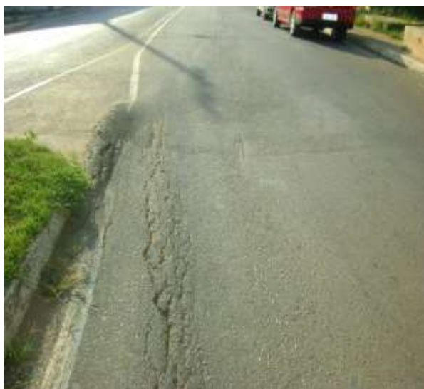
Figura 4.43A: Avenida Tancredo Neves – Afundamento nas trilhas de roda sem solevamento lateral no logradouro.
