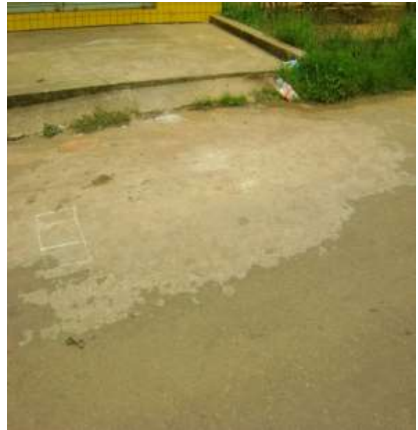
Figura 4.17B: Ala 05 – Presença de derrame de materiais.
