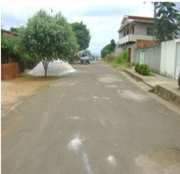
Figura 4.13A: Ala 01 – Presença de derrame de materiais na via.
