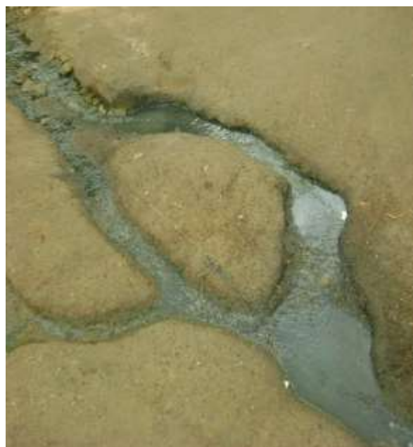
Figura 4.16B: Ala 04 – Presença de panela.
