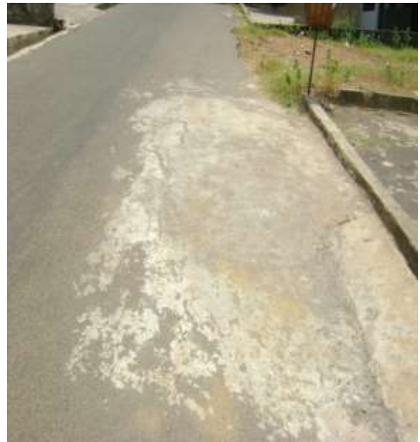
Figura 4.14B: Ala 02 – Presença de derrame de materiais.
