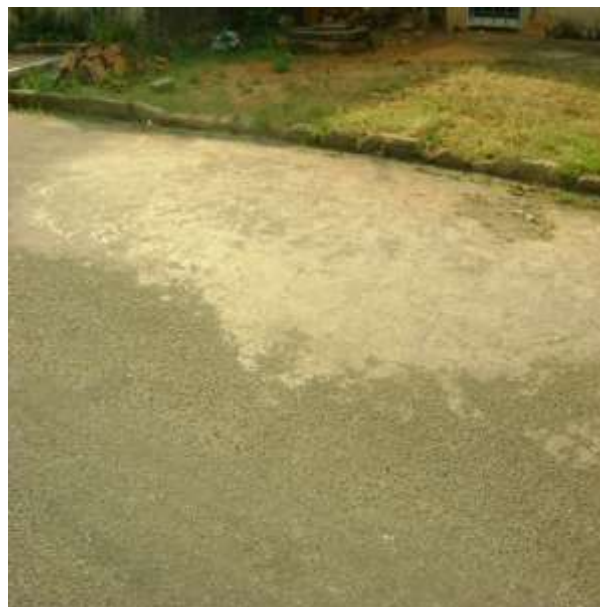
Figura 4.26B: Ala E – Presença de derrame de materiais.
