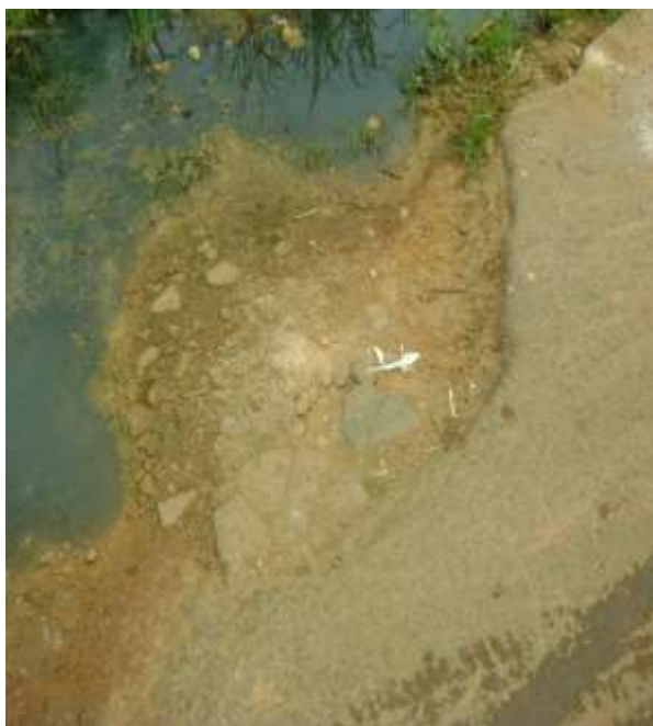
Figura 4.34A: Travessa W1 – Presença de panela.
