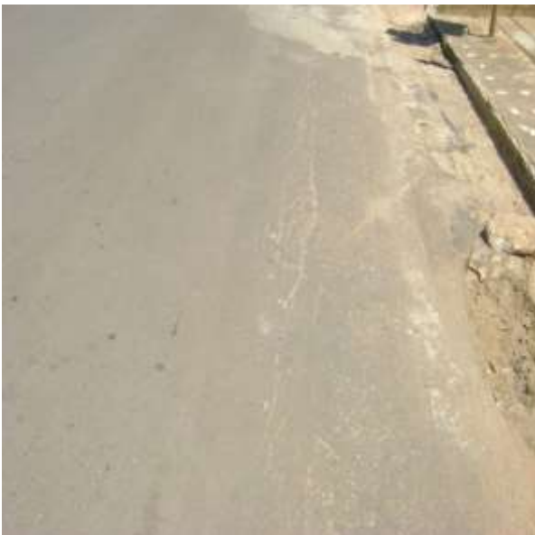
Figura 4.8C: Avenida Perimetral – Trinca de retração.
