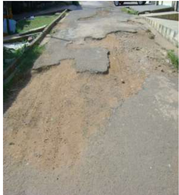
Figura 4.22B: Ala 10 – Presença de panela e derrame de materiais.
