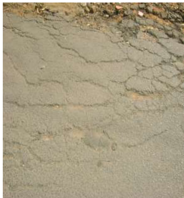
Figura 4.31B: Rua das Rosas – Presença de trincas de retração.
