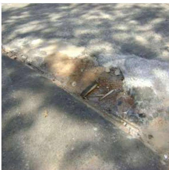
Figura 4.37A: Travessa W4 – Presença de panela, desgaste superficial e derrame de materiais.
