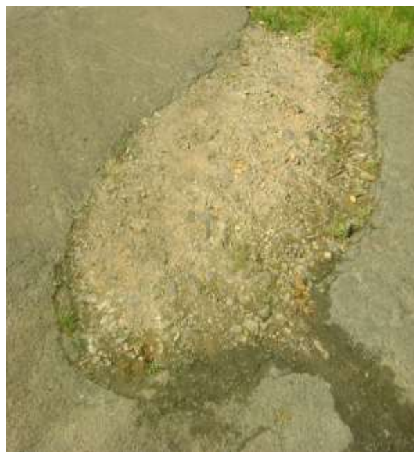
Figura 4.21B: Ala 09 – Presença de derrame de materiais.
