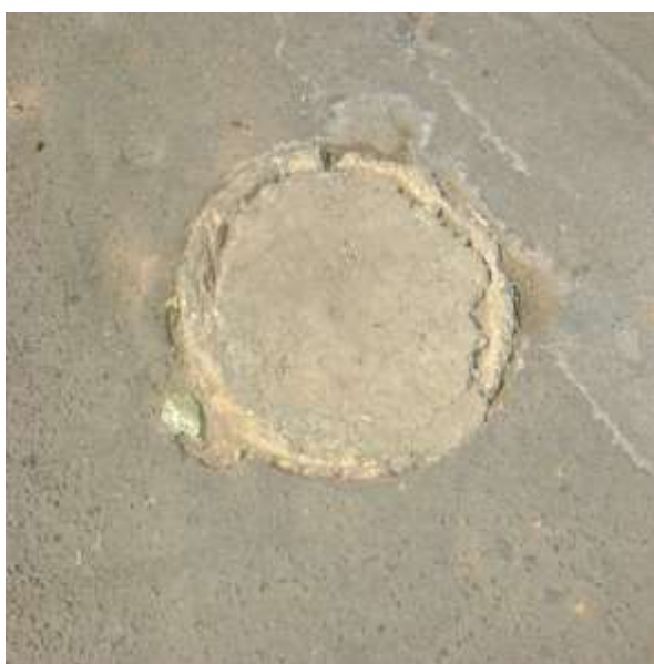
Figura 4.42A: Avenida 31 de Março – Presença de remendo de conservação em PV.
