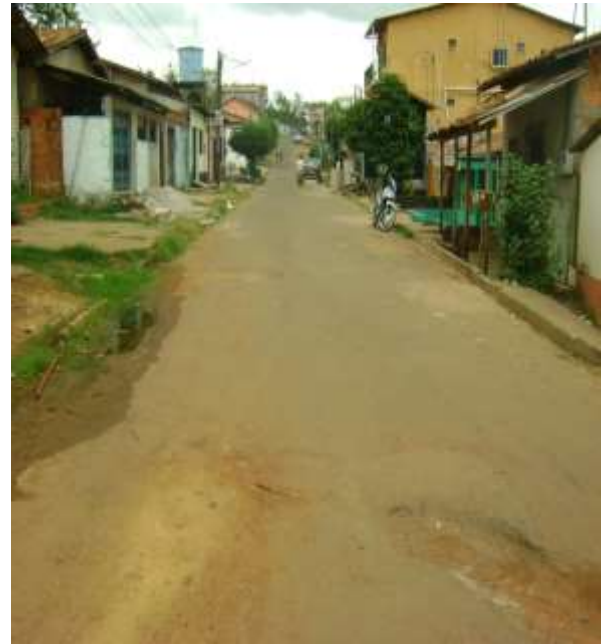
Figura 4.20B: Vista frontal no início do logradouro e presença de panela.
