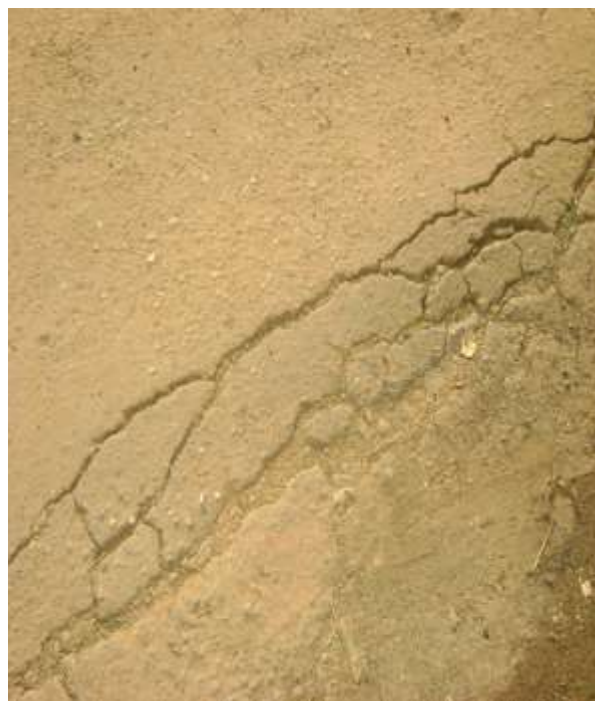
Figura 4.29B: Rua Juscelino Kubischek – Presença de trincas de retração.
