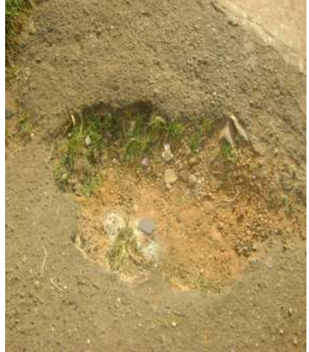
Figura 4.12B: Rua Fortaleza – Presença de panela.
