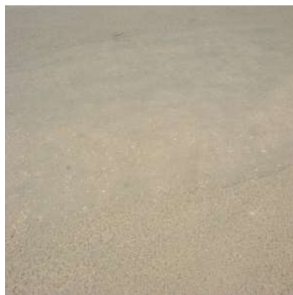
Figura 4.42B: Avenida 31 de Março – Presença de desgaste superficial no logradouro.
