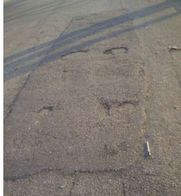
Figura 2.7B: Remendo superficial mal-executado. Disponível
