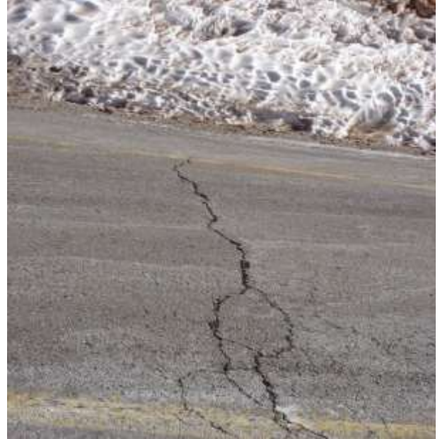
Figura 2.4B: Trinca de Retração Térmica. Disponível em: < http://www.ebah.com.br/content/ABAAABBRgAE/defeitos-pavimentos >. Acesso em: 13 março 2012.
