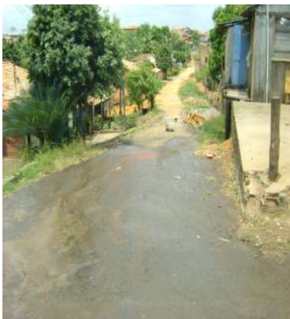
Figura 4.39A: Travessa Alto Alegre – Vista frontal do logradouro e presença de panela.
