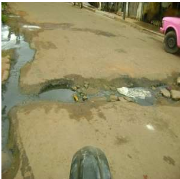
Figura 4.18A: Ala 06 – Presença de panela.
