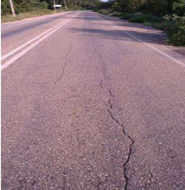
Figura 2.4A: Trinca Longitudinal Longa (devido ao tráfego). Disponível em: < http://www.ebah.com.br/content/ABAAABBRgAE/defeitos-pavimentos >. Acesso em: 13 março 2012.
