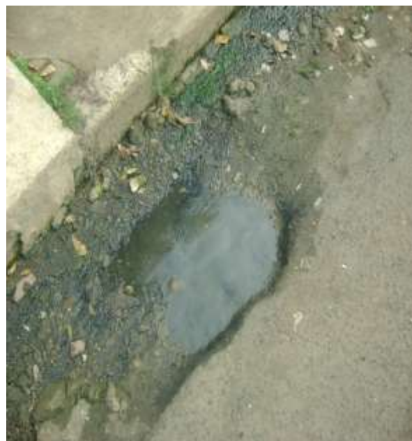
Figura 4.24B: Ala 13 – Presença de panela.
