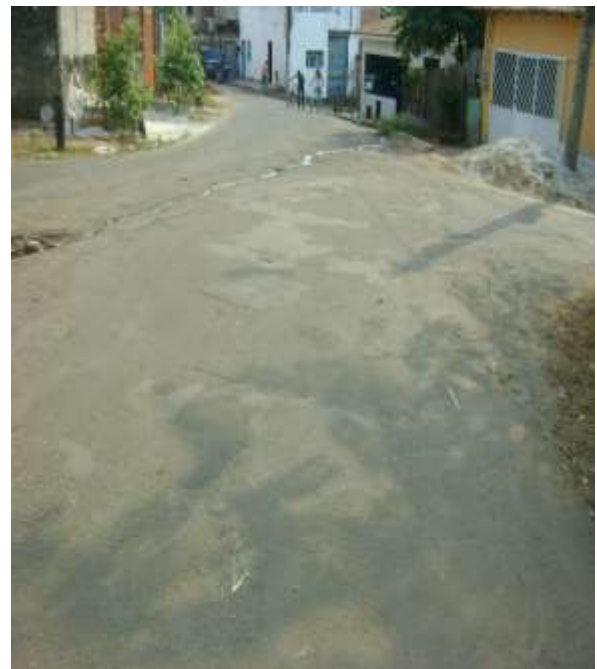
Figura 4.28B: Rua dos Lírios – Presença de derrame de materiais.
