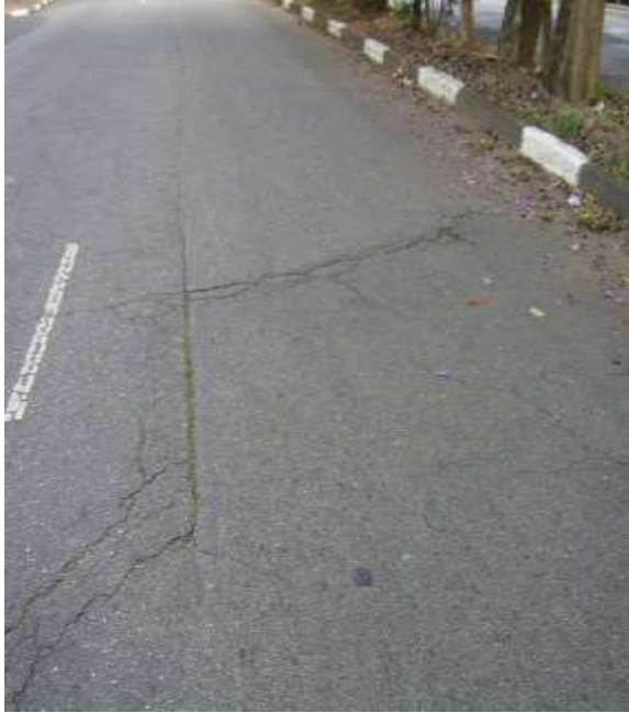
Figura 2.7A: Trincamento Transversal. Fonte: Kawano et. al. (2010).
