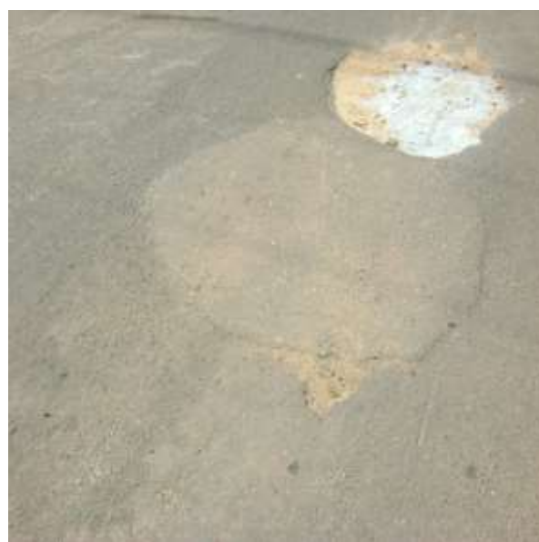
Figura 4.37B: Travessa W4 – Presença de panela, remendo e desgaste superficial.
