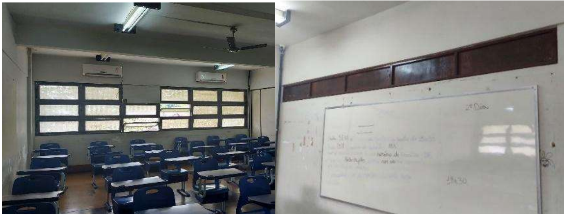
Figura 18– sala de aula do terceiro pavimento: A) Esquadria de madeira; B) Persiana da sala vedada com madeira.
