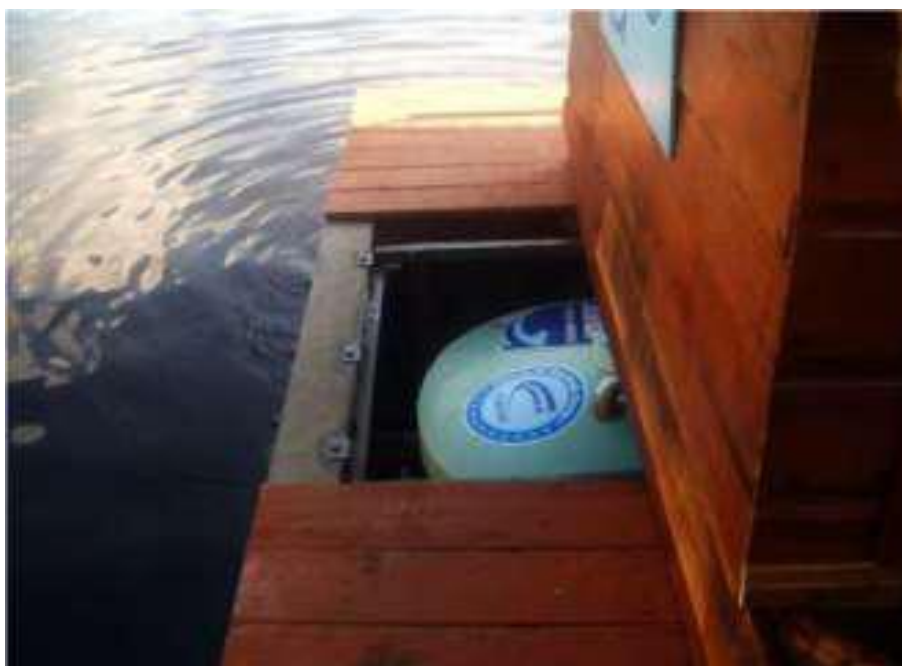
Fig. 84. Biodigestor instalado em um restaurante flutuante em Manaus. Fonte: Jair Antônio de Oliveira Junior, pg. 128.
