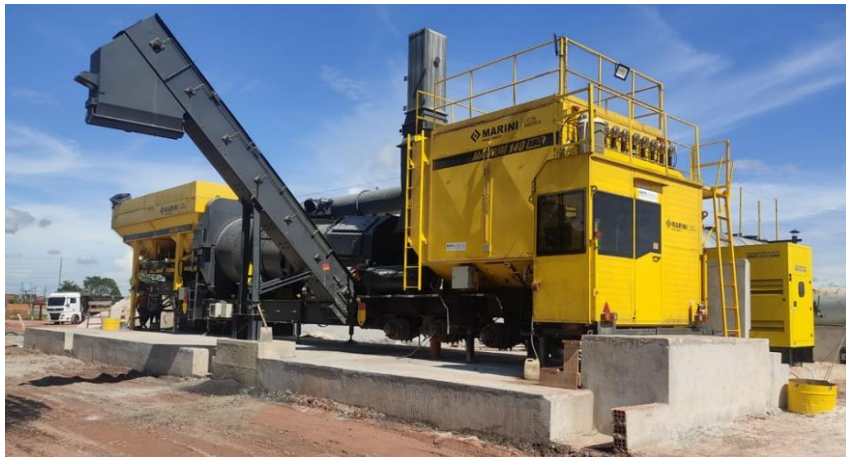
Figura 14 - Visão geral da usina Norte Ambiental Gestão e Serviços LTDA.
