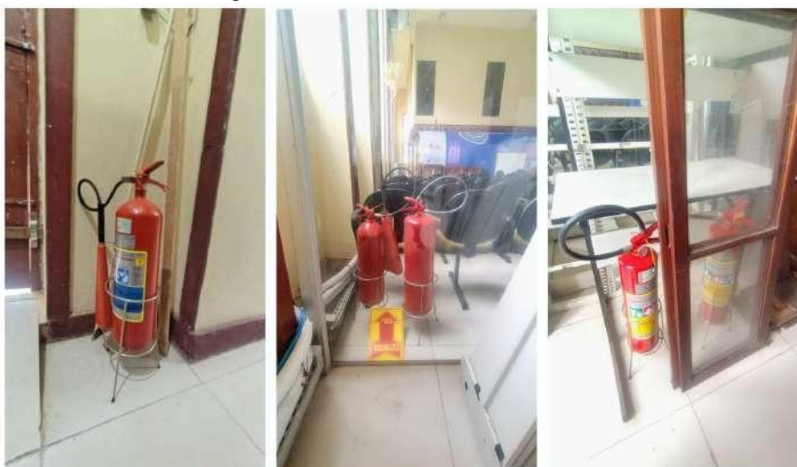
Figura 6 - Extintores no CMA
