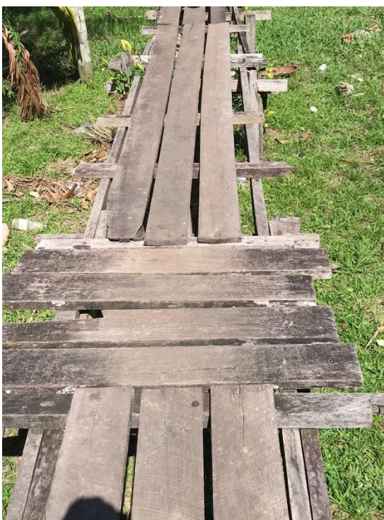
Figura 12 - Condições das estivas de acesso ao terreno da sede Fonte: Autor
