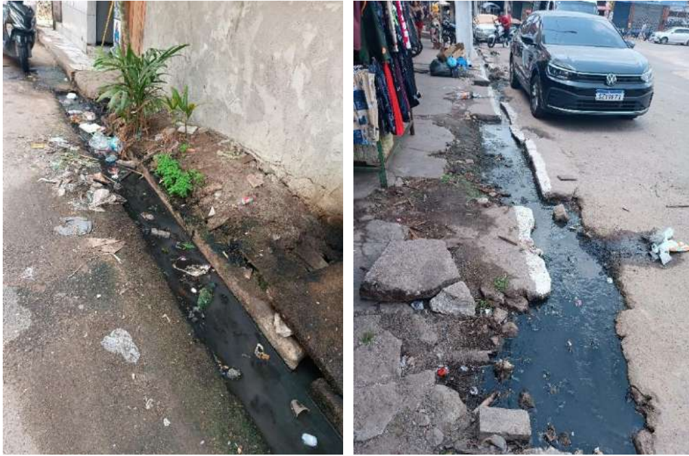
FIGURA 23 e 24 – AUSÊNCIA DE MICRODRENAGEM NA ÁREA
