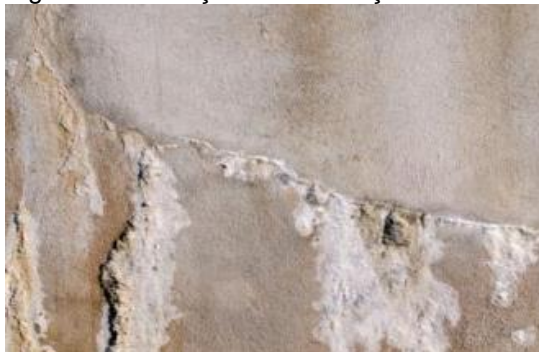
Figura 7 - infiltração em edificações: fluorescências e bolores.
