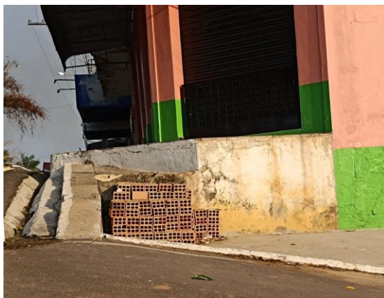
Figura 4 - Desnível da calçada 5.
