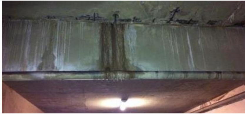
Figura 10 – Infiltrações em estrutura predial
