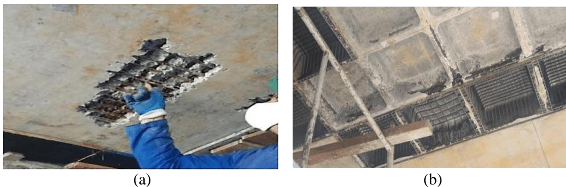
Figura 7 – Segregação do concreto
