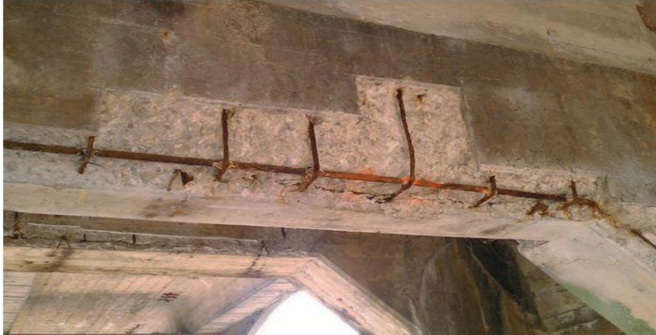
Figura 4 – Corrosão da armadura
