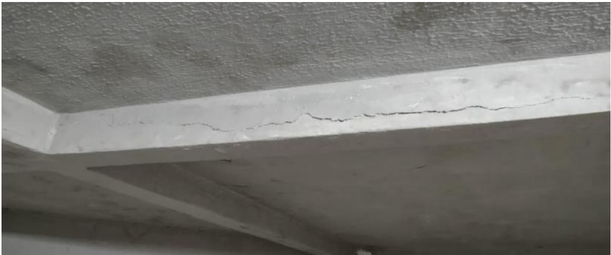
Figura 8 - Fissuras em viga de concreto armado
