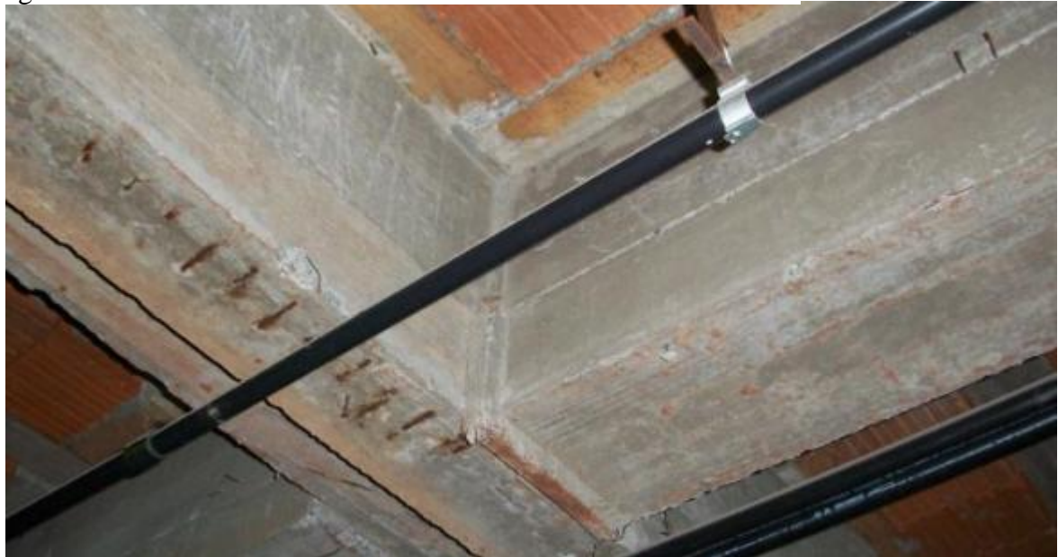
Figura 3 – Cobrimento deficiente da armadura
