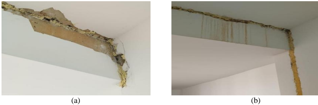
Figura 14 – Dano na junta de dilatação
