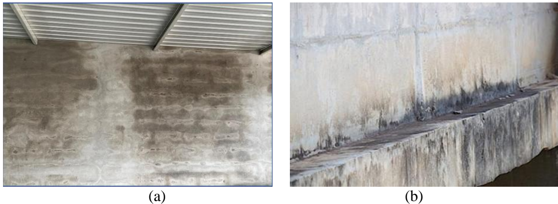
Figura 9 – Manchas em estruturas de concreto
