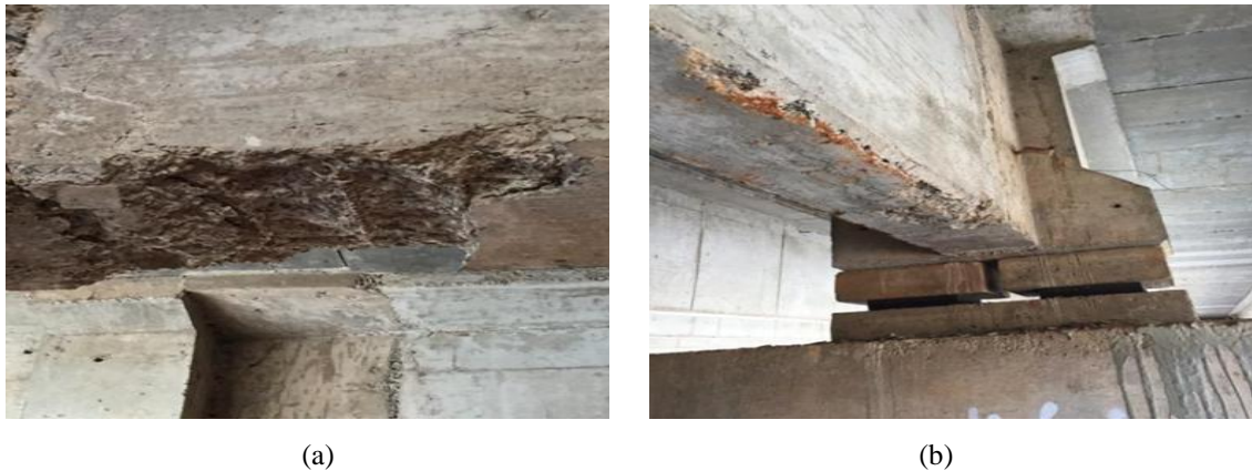
Figura 5 – Desagregação do concreto
