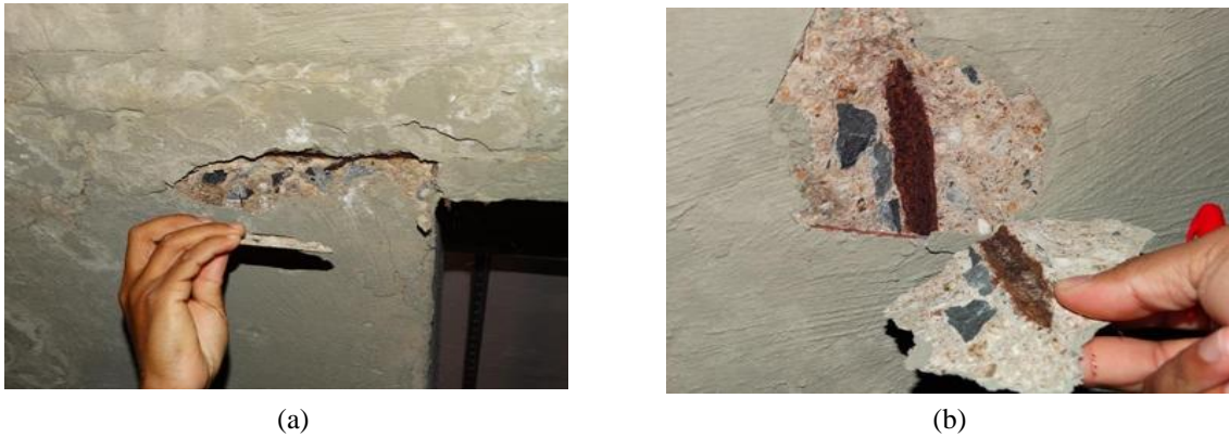
Figura 6 – Deslocamento do concreto
