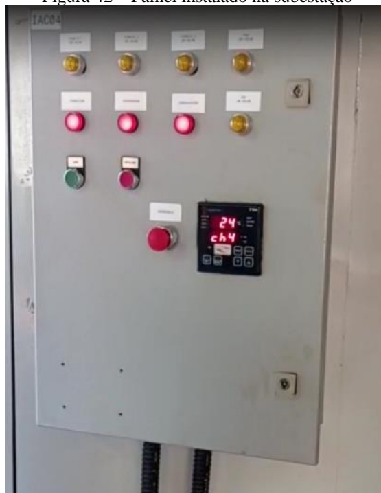
Figura 42 – Painel instalado na subestação
