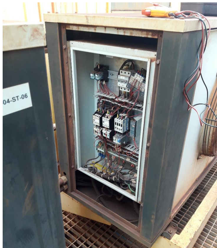
Figura 16 – Antigo painel elétrico do sistema de refrigeração
