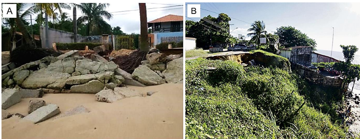
Figura 4.5 Efeitos da erosão em praias da Ilha de Mosqueiro: (A) Barreiras de concreto na orla da praia do Marau; (B) Colapso de falésia e desmoronamento de trecho da avenida Beira Mar, na Praia Grande. Residências em situação de alto risco de desmoronamento. Fonte: A - Neves & França (2016). B - Diário Online Pará (2019).
