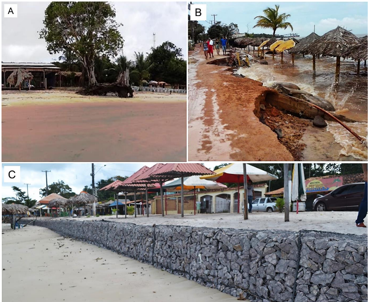
Figura 4.9 Erosão na Praia do Caripi, município de Barcarena: (A) Exposição de raízes de árvores de grande porte, evidências da continua remoção do sedimento praias por efeito da erosão; (B) Calçadas e barracas sendo destruídas pelo efeito de ondas e maré na orla da Praia do Caripi; (D) Muro de contenção construído para conter a erosão na orla da Praia do Caripi. Fontes: A – Rocha (2016); B – Elídio (2019); Prefeitura de Barcarena (2019).
