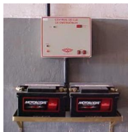
Figura 22 – Sistema centralizado de bateria de acumuladores.
