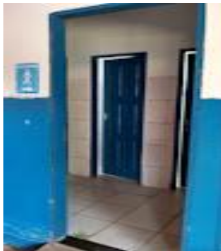
Figura 3: Entrada de banheiro estreita para cadeirantes, sem adaptação. Fonte: Ferreira e Costa, 2021.
