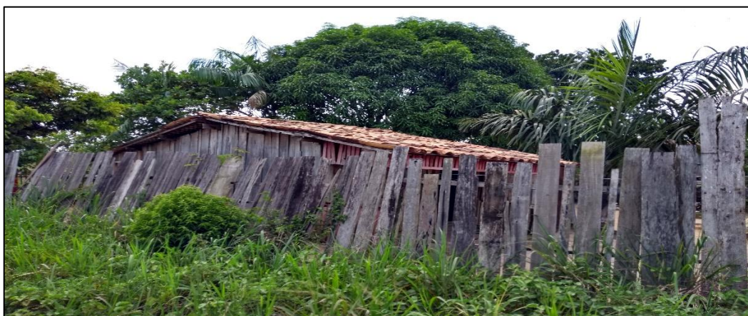
Figura 3 – Condições estruturais das moradias no entorno
