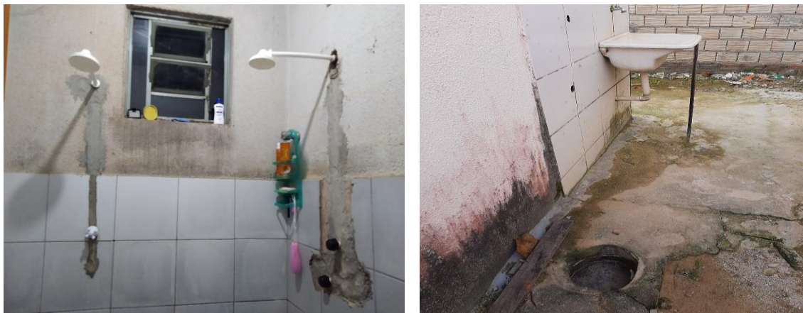
Figura 4 – Manifestações patológicas em instalações hidrossanitárias
