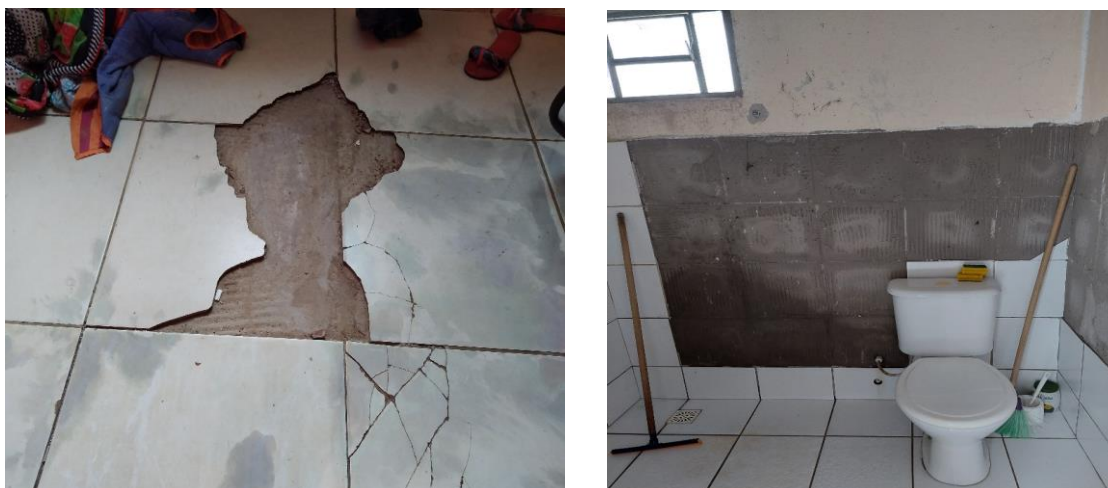
Figura 2 – Manifestações patológicas no revestimento cerâmico
