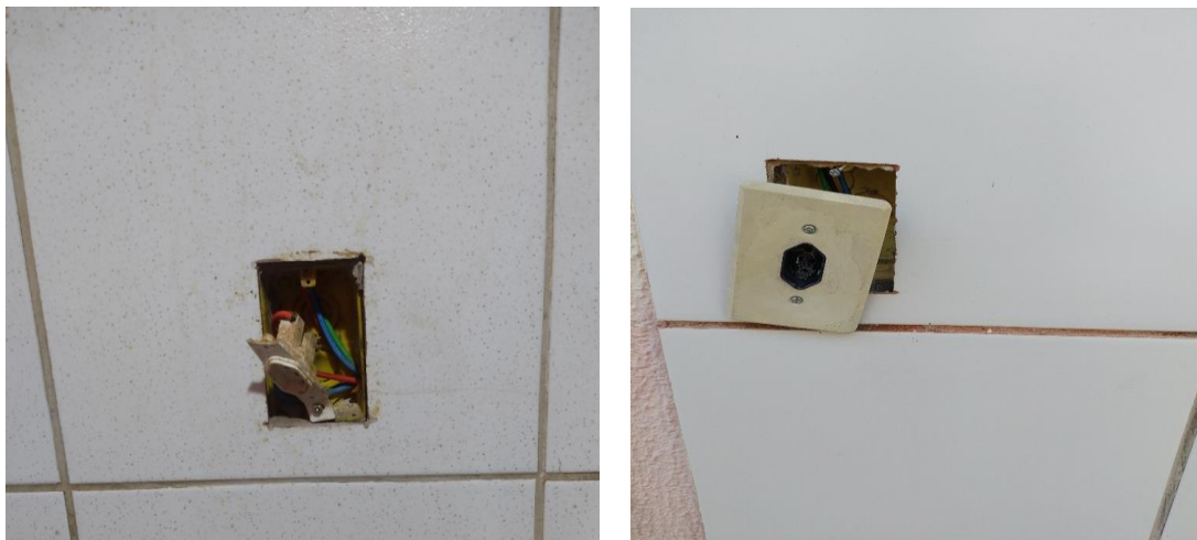
Figura 6 – Manifestação patológicas nas instalações elétricas
