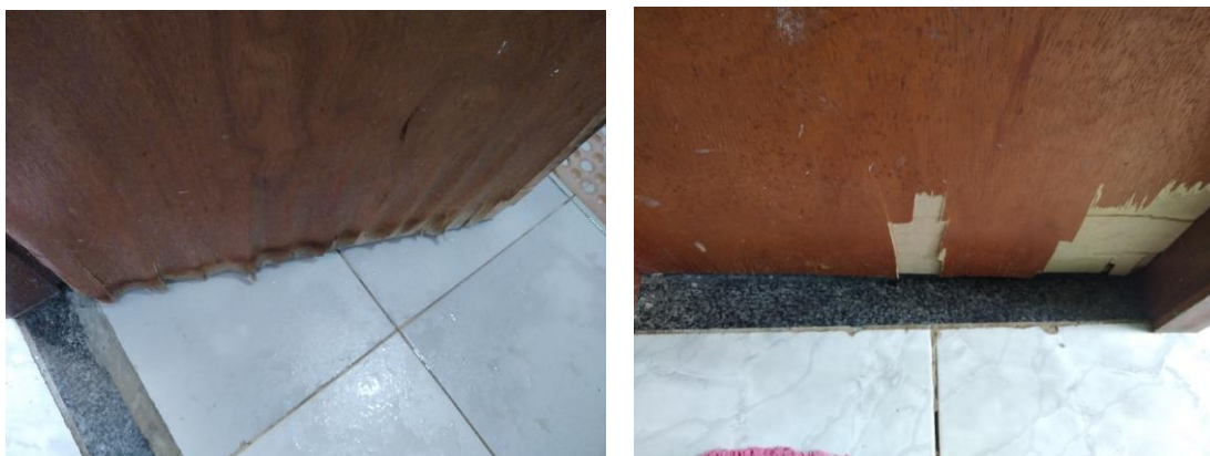
Figura 5 – Danos relacionados nas esquadrias internas
