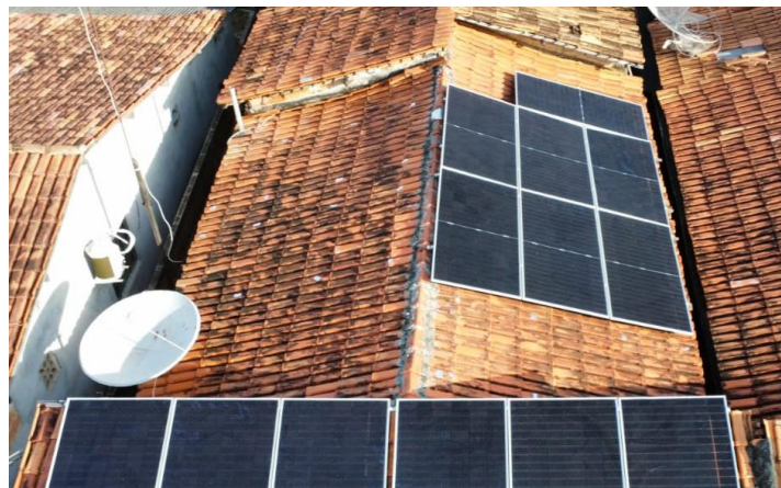
Figura 20 - Instalação com módulos bifaciais.
