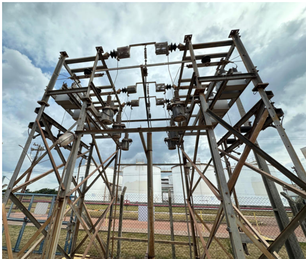
Figura 34 – Vista geral do Banco de Capacitores BCP-03.
