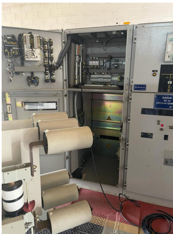
Figura 42 – Vista interna do cubículo do alimentador K14
