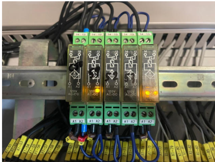
Figura 54 – Relés auxiliares de interface para realimentação de posição
