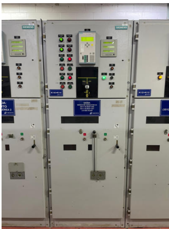
Figura 25 – Vista frontal do cubículo do alimentador K14.
