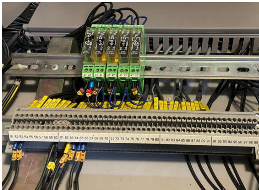
Figura 53 – Infraestrutura de borneiras e interligação dos circuitos de automação
