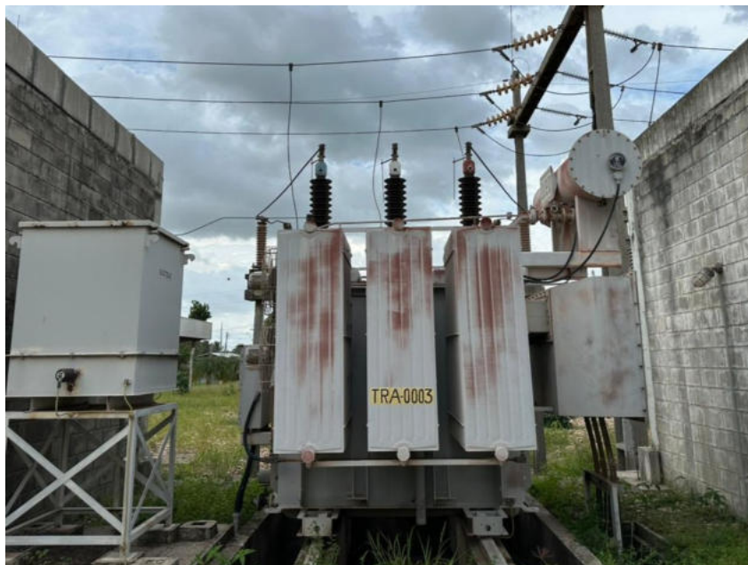
Figura 20 – Vista frontal do transformador de potência TRA-03.
