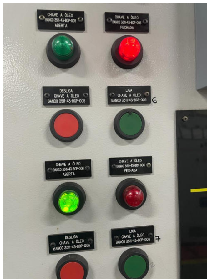
Figura 38 – Botoeiras de acionamento local dos estágios do Banco de Capacitores BCP-03.
