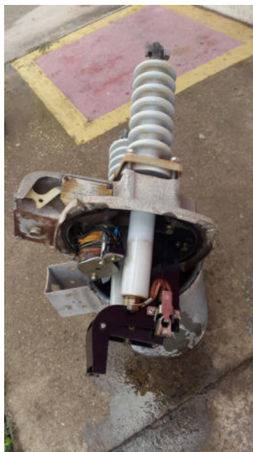
Figura 32 – Vista interna do dispositivo de manobra utilizado nos estágios capacitivos.
