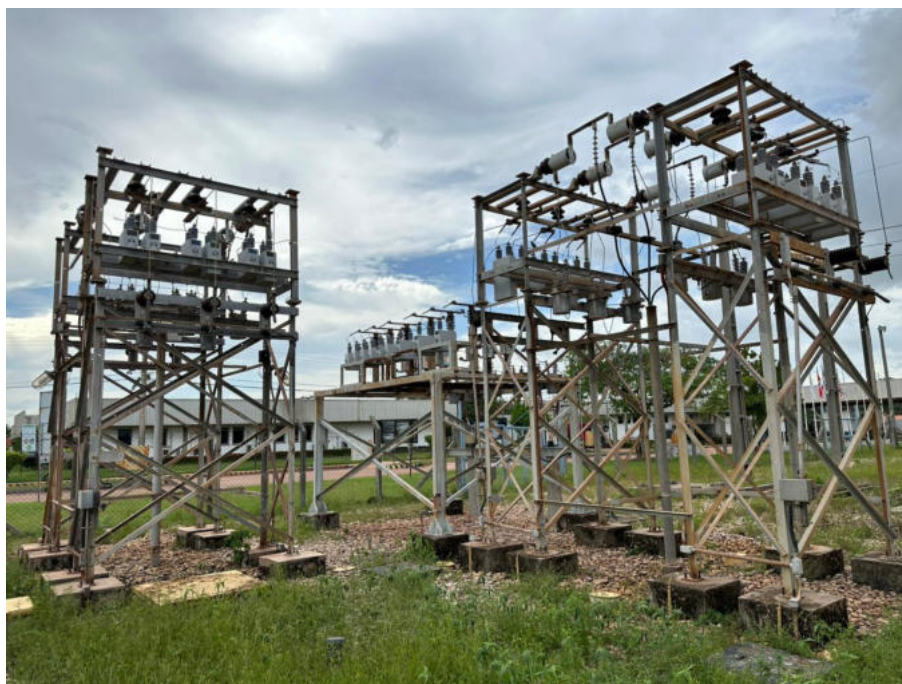
Figura 26 – Vista geral dos bancos de capacitores instalados no pátio da subestação.
