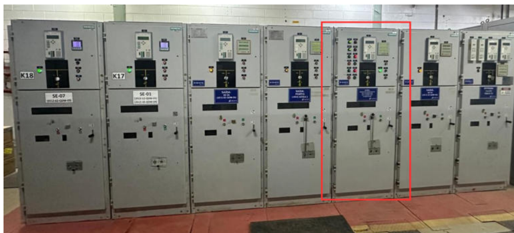
Figura 24 – Painéis de média tensão com relés de proteção associados ao barramento do transformador TRA-03.
