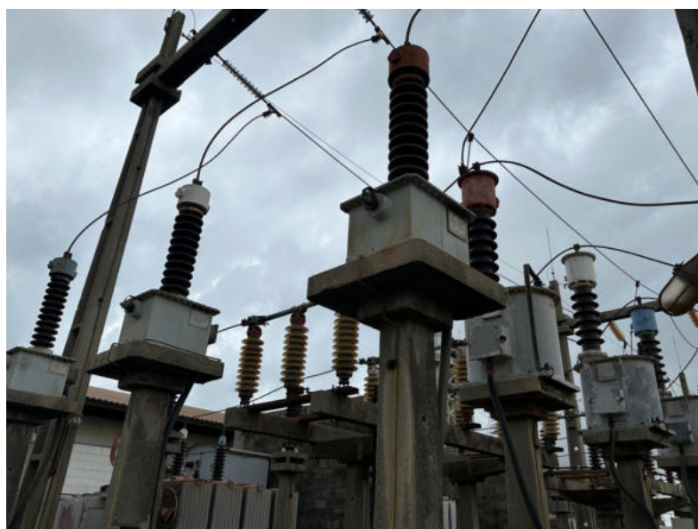
Figura 17 – Transformadores de potencial instalados no pátio da subestação.
