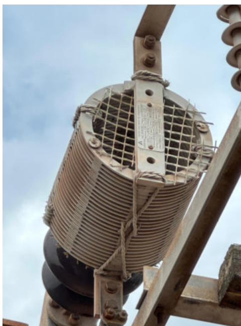
Figura 30 – Indutor de dessintonia instalado no banco de capacitores em média tensão.
