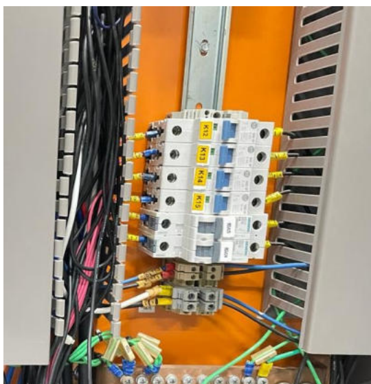
Figura 51 – Disjuntor auxiliar de habilitação da automação (K14)
