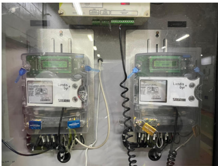
Figura 18 – Medidores eletrônicos de energia da concessionária instalados no painel de medição.
