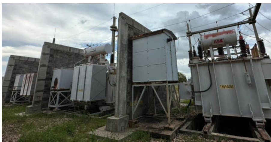
Figura 19 – Vista geral dos transformadores de potência instalados na subestação.
