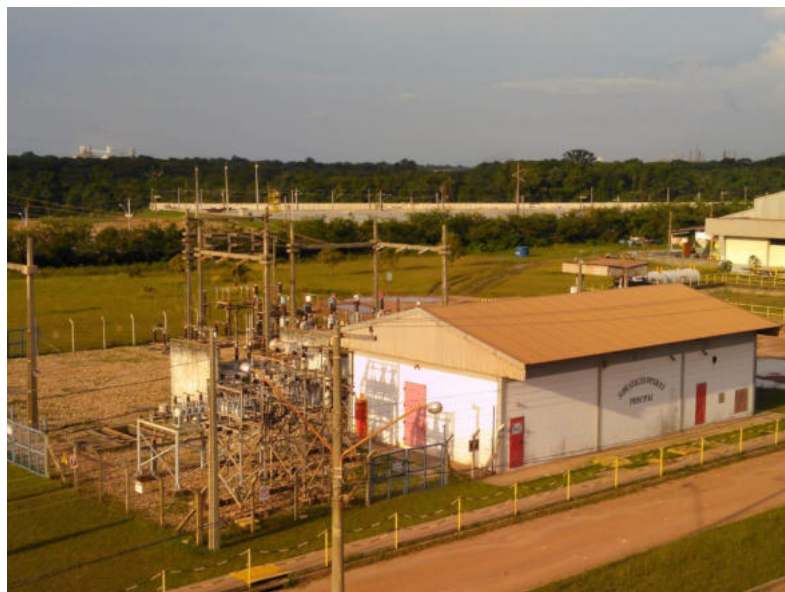
Figura 12 – Vista aérea da subestação elétrica da planta industrial
