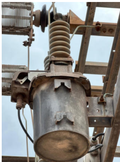
Figura 31 – Dispositivo de manobra instalado no banco de capacitores.
