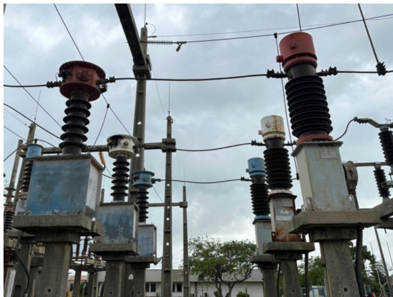
Figura 16 – Transformadores de corrente instalados no pátio da subestação.
