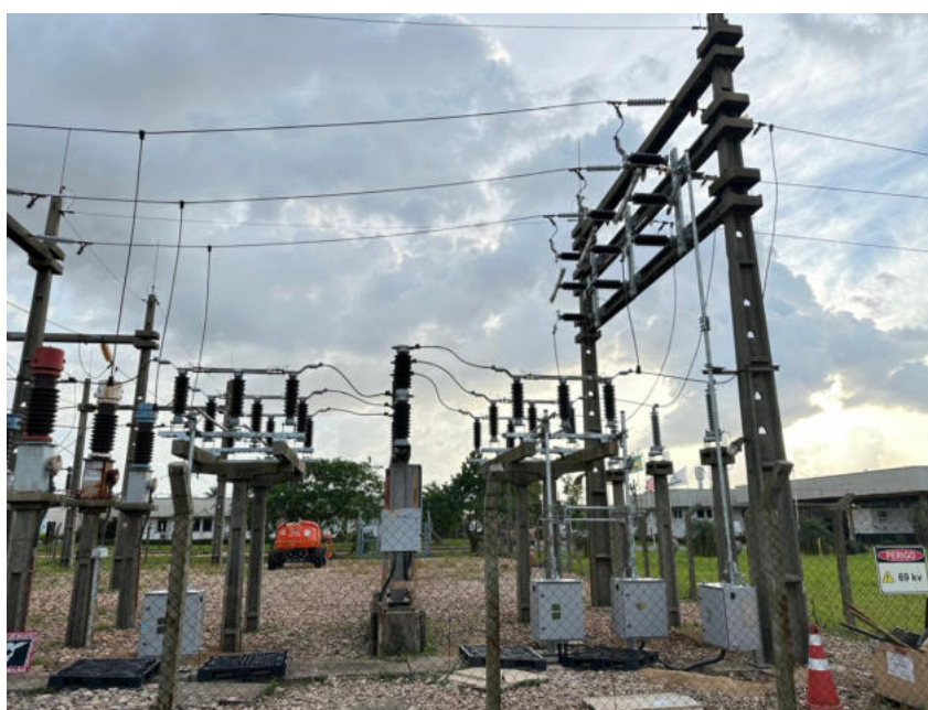
Figura 14 – Pátio de alta tensão da subestação com estruturas de chegada da linha de 69 kV
