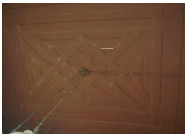
Figura 60: Forro da Administração
