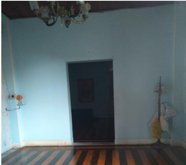
Figura 28: Paredes em azul pastel – SALA DE IOGA
