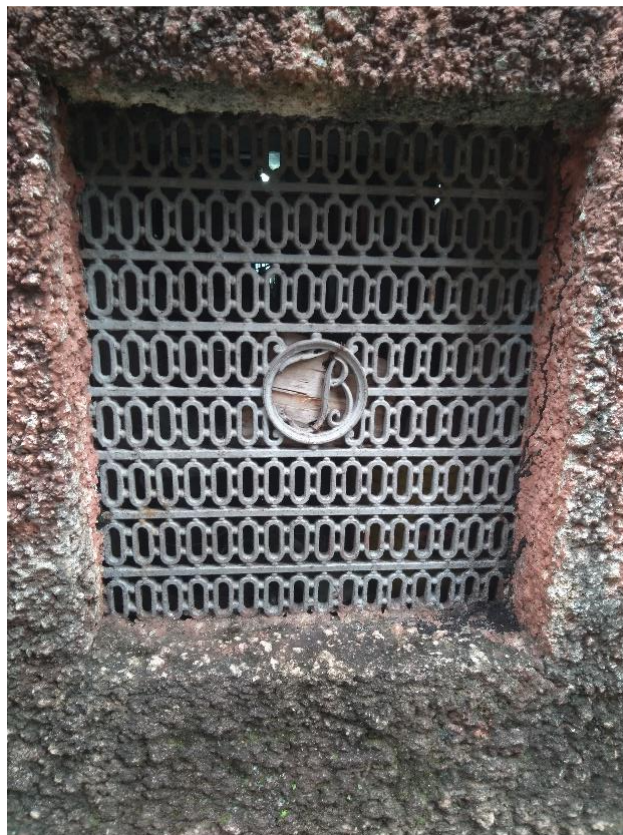
Figura 45: Óculos do Porão em ferro fundido – com danos
