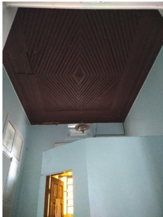
Figura 56: Forros de Ventilação pavimento superior
