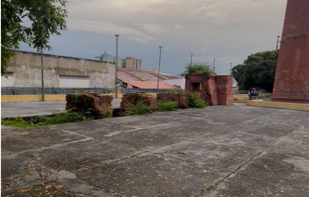
Figura 23: Estrutura do Forno Deteriorada após revitalização de 2024
