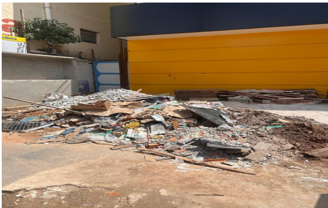
Figura 4: Resíduos de Construção Civil e Demolição advindas de Obras Públicas de Cametá-Pa.
