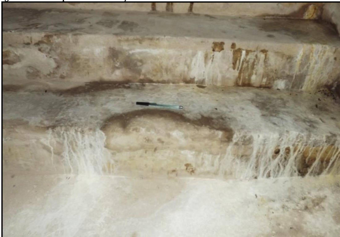
Fotografia 13 - Caso pontual de lixiviação na escada localizada sobre o canal de enchimento da Eclusa 1.
