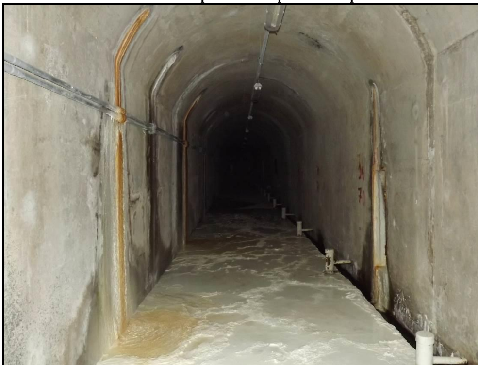
Fotografia 8 - Vista geral da galeria de drenagem do Bloco 1-A1, cota 26,50 m, onde é possível observar eflorescências depositadas nas paredes e no piso.
