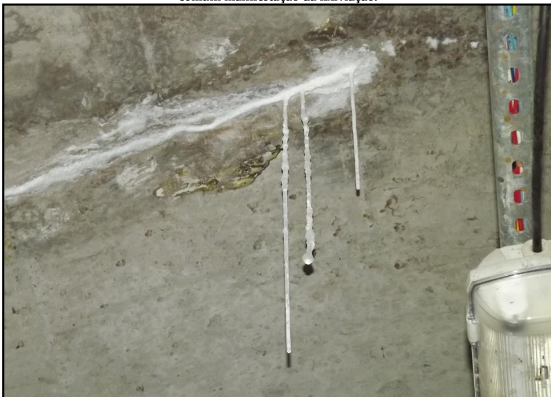
Fotografia 14 - Em alguns locais nota-se a formação de estalactites no teto na galeria de drenagem, outra comum manifestação da lixiviação.
