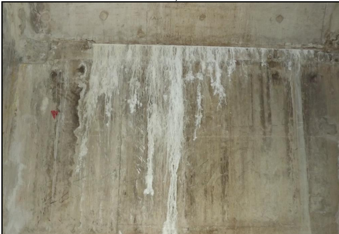
Fotografia 15 - Ocorrência de lixiviação em partes específicas de algumas paredes da galeria de drenagem, especialmente no contato concreto moldado in loco (nas paredes) e concreto pré-moldado (na abóbada do teto).
