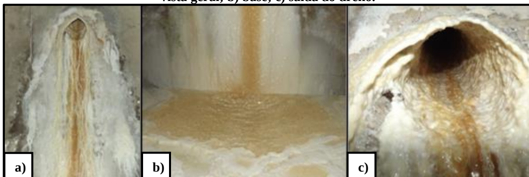
Fotografia 10 - Detalhamento de outro dreno, também com grande quantidade de eflorescência, sendo: a) vista geral; b) base; c) saída do dreno.
