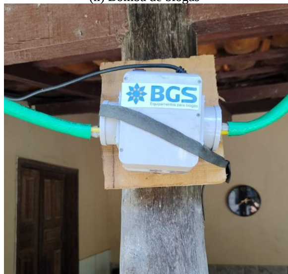
(n) Bomba de biogás
