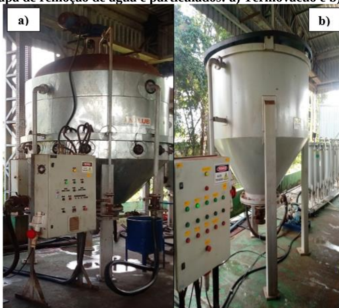
Figura 12. Etapa de remoção de água e particulados: a) Termovácuo e b) Desarenador.
