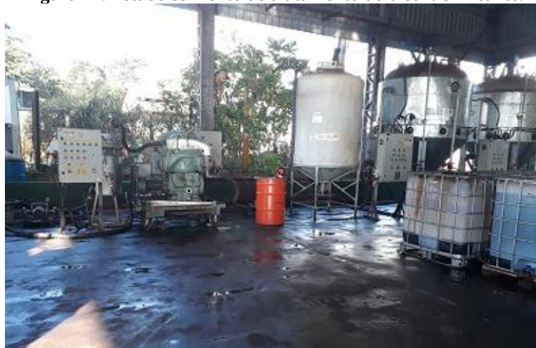
Figura 17. Estabelecimento de tratamento do óleo lubrificante.
